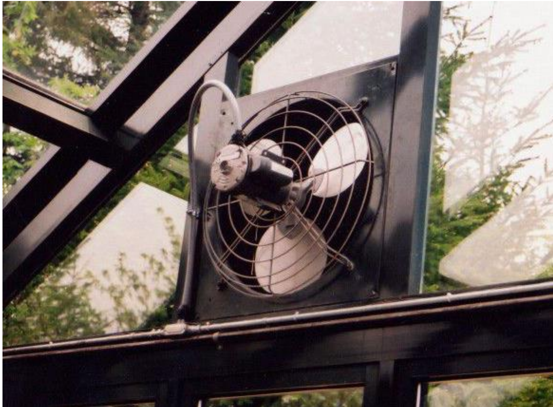
Εικόνα 5.8: Τυπική μορφή ενός ηλεκτρικού εξαεριστήρα
