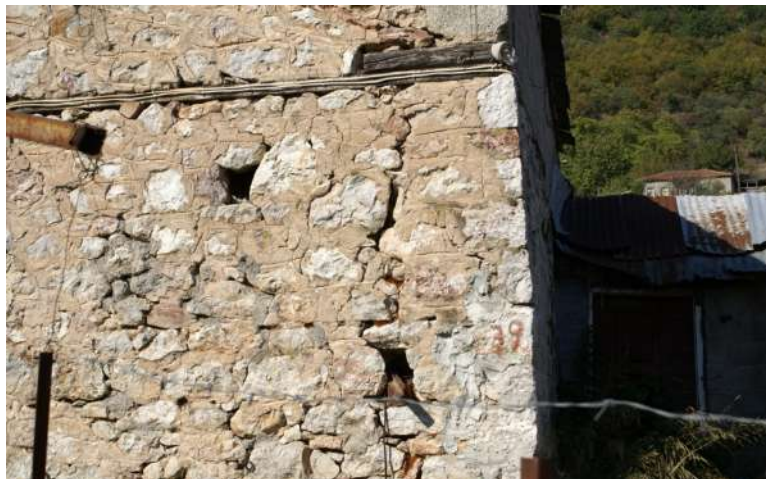
Σχήμα 2.8 Ρηγμάτωση με υποχώρηση μικρών λίθων ( http://5a.arch.ntua.gr/project/15627/16197 )
