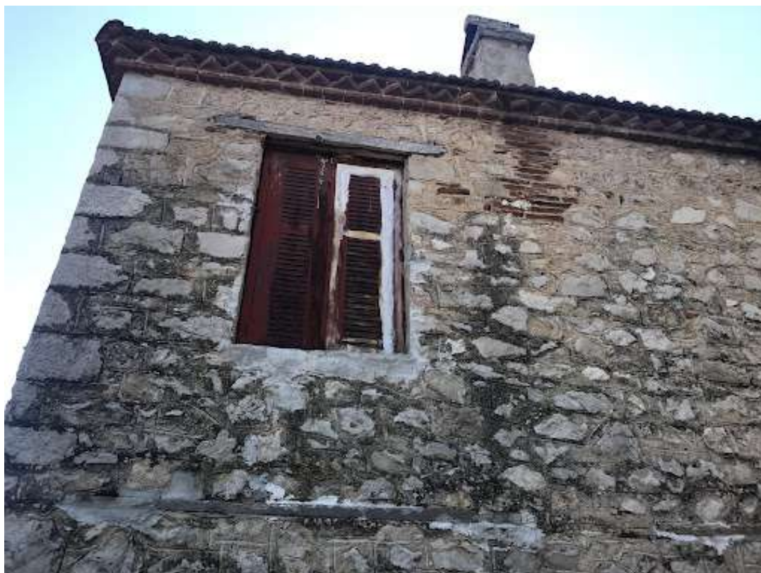
Σχήμα 2.10 Υγρασία σε κτίριο τοιχοποιίας( http://5a.arch.ntua.gr/project/15627/16197 )
