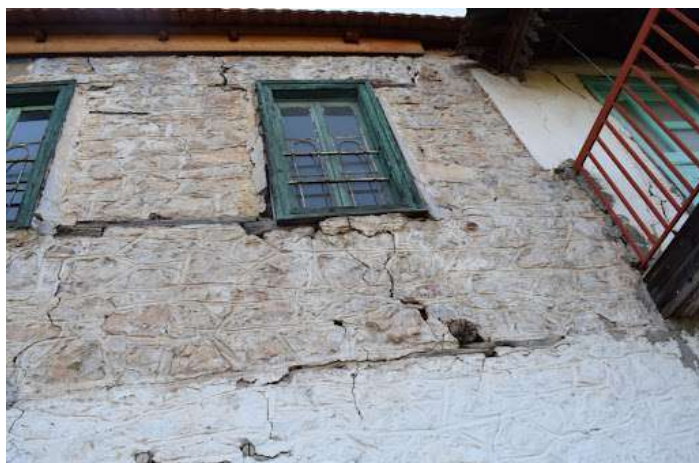
Σχήμα 2.11 Υποχώρηση - φθορά συνδετικού κονιάματος περιμετρικά ανοίγματος ( http://5a.arch.ntua.gr/project/15627/16197 )
