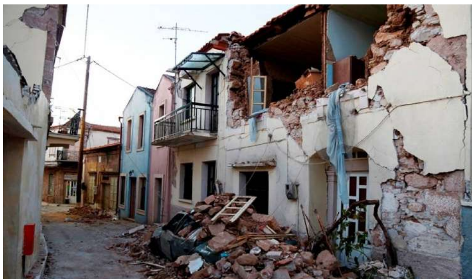
Σχήμα 2.9 Αστοχία κατασκευής στο χωριό Βρίσα στην Μυτιλήνη ( https://www.newsbomb.gr/ellada/story/799713/seismos-mytilini-xorio-fantasma-i-vrisa-synttrimmia-kai-apognosi-pantoy )
