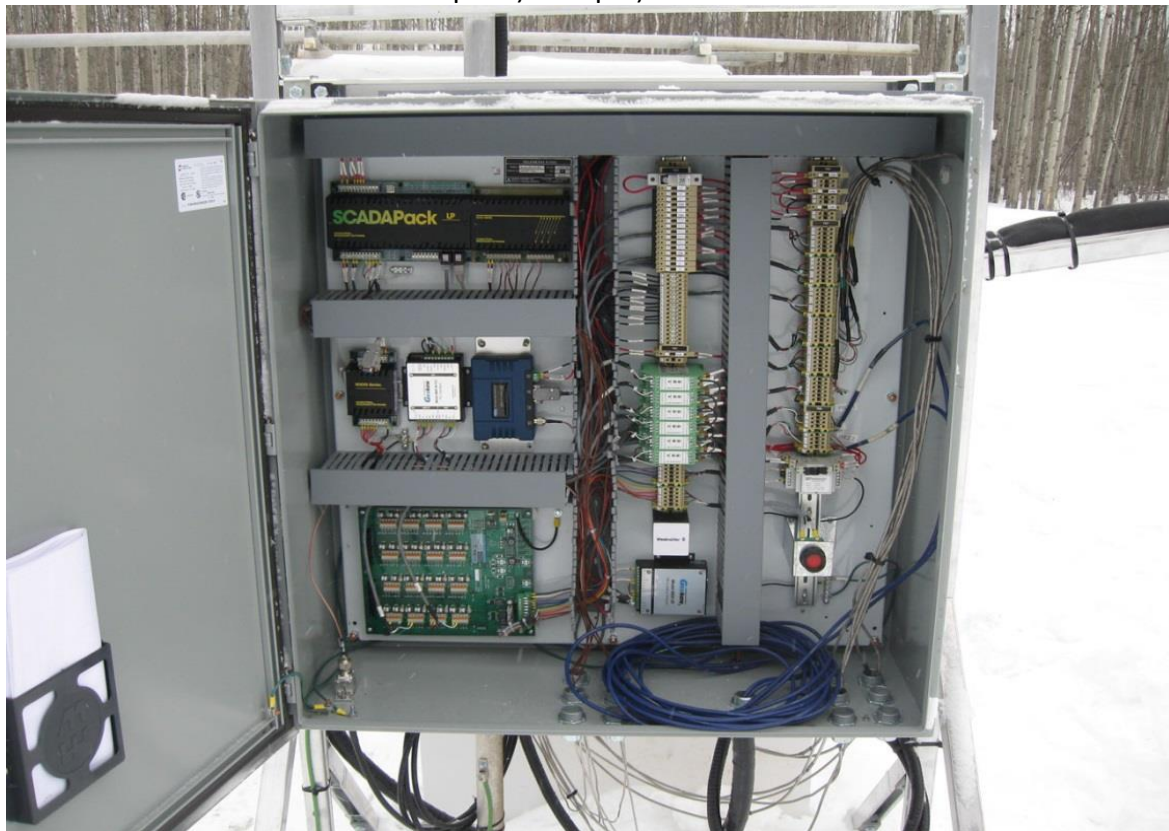
Εσωτερική εγκατάσταση RTU
