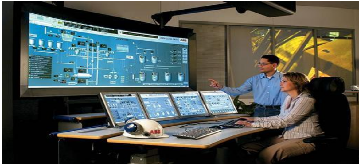
Κεντρικός σταθμός Scada
