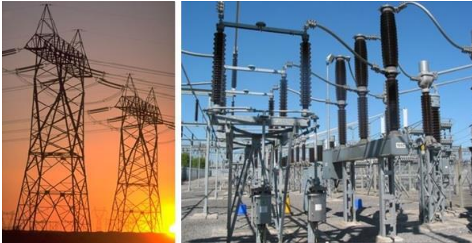
Γραμμές ΥΤ και Υποσταθμός Μεταφοράς ΥΤ
