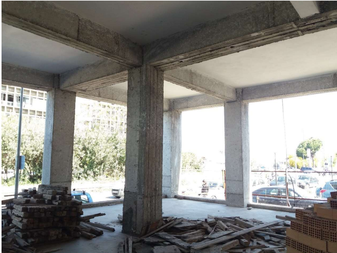
Εικόνα 25. Ενισχυμένα υποστυλώματα στο κτήριο Α. ( Πηγή: Προσωπικό αρχείο)
