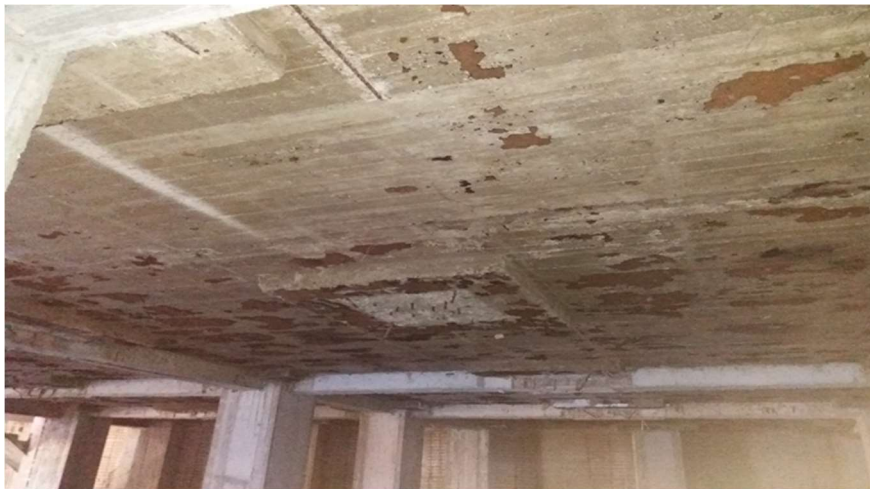
Εικόνα 14. Άποψη από το υπόγειο του κτηρίου Β με μυκητοειδής πλάκες. (Πηγή: Προσωπικό αρχείο).
