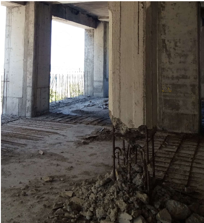
Εικόνα 17. Παλιό υποστύλωμα προς αφαίρεση στον Β' όροφο του κτηρίου Β . Πίσω το νέο υποστύλωμα μετά την ενίσχυση (Πηγή: Προσωπικό αρχείο)
