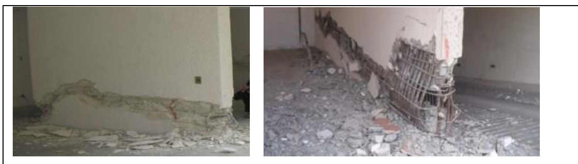
Εικόνα 11 Αριστερά, καμπτική αστοχία τοιχώματος & Δεξιά, καμπτική αστοχία θλιβόμενης ζώνης. (Μπισκίνης Διονύσιος, Παρουσιάσεις μαθήματος, Πανεπιστήμιο Πελοποννήσου).
