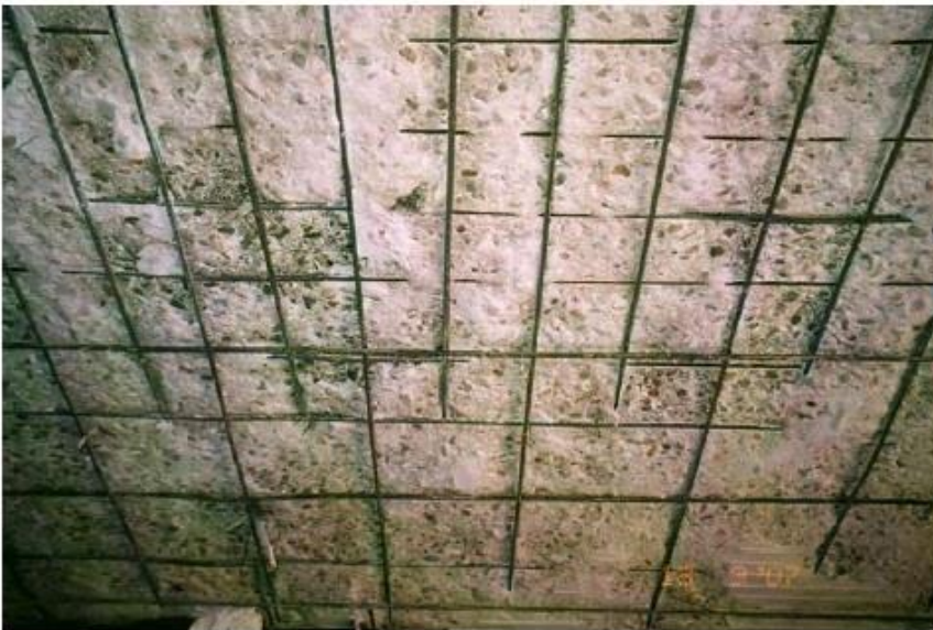
Εικόνα 14: Εκτεταμένη Αποσύνθεση Σκυροδέματος
