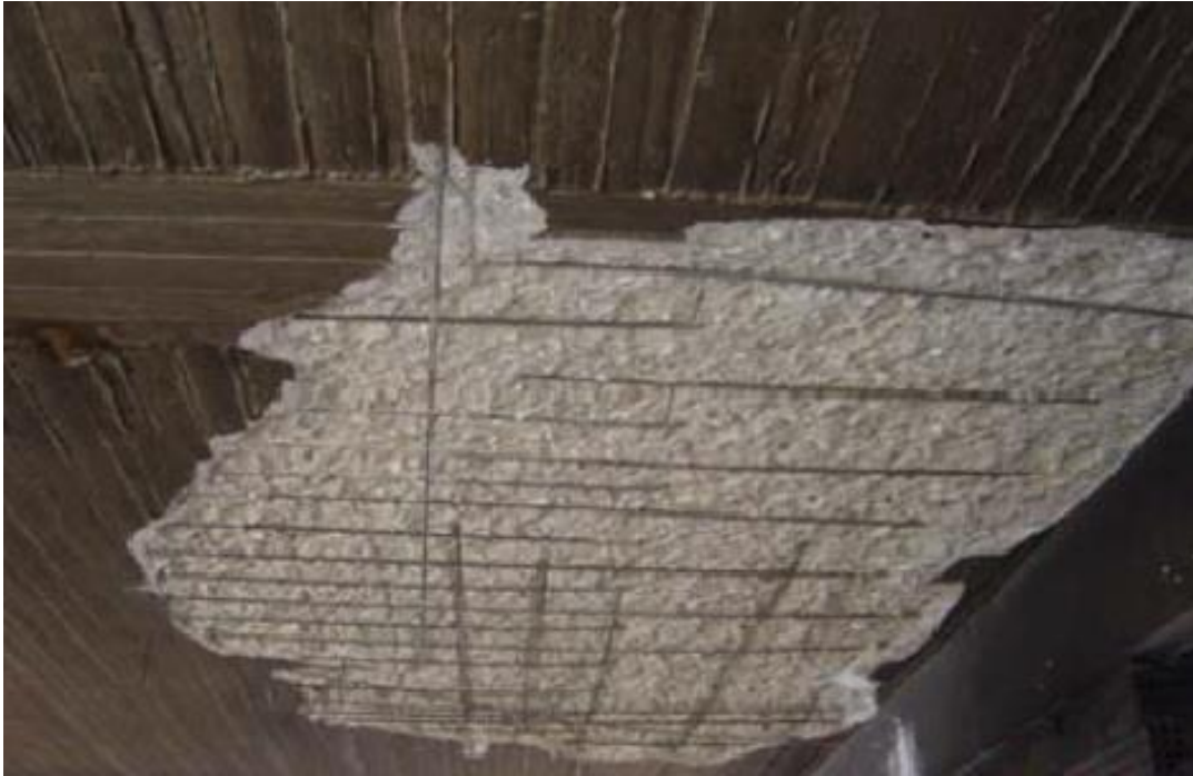
Εικόνα 18: Θραύση Ράβδων Οπλισμού Πλάκας
