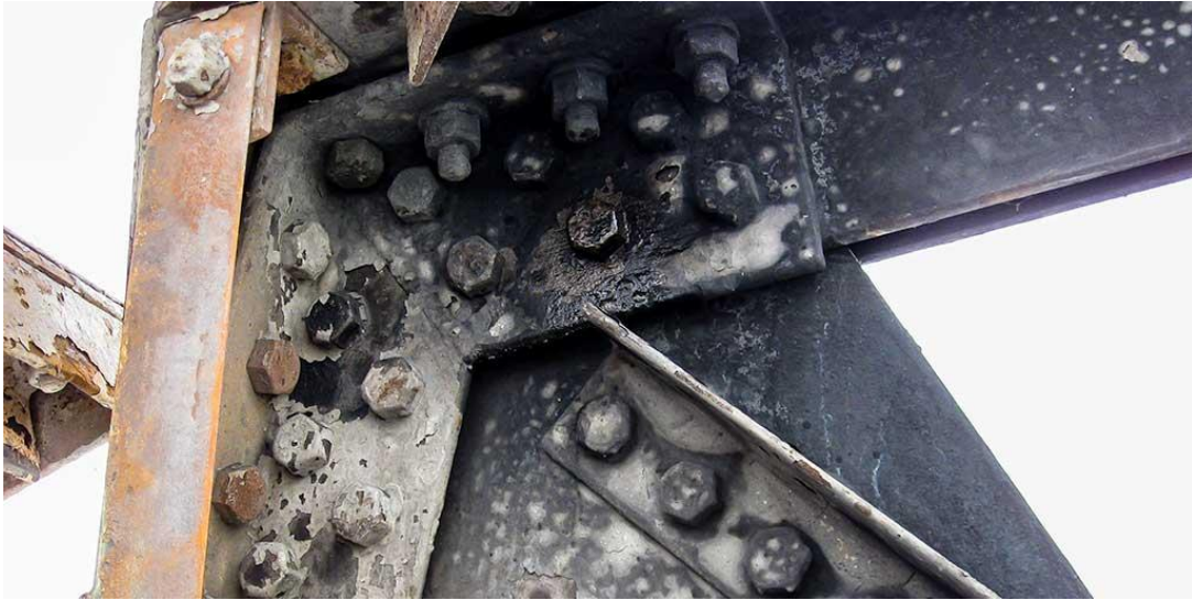
Εικόνα 20: Οξείδωση Μεταλλικού Στοιχείου
