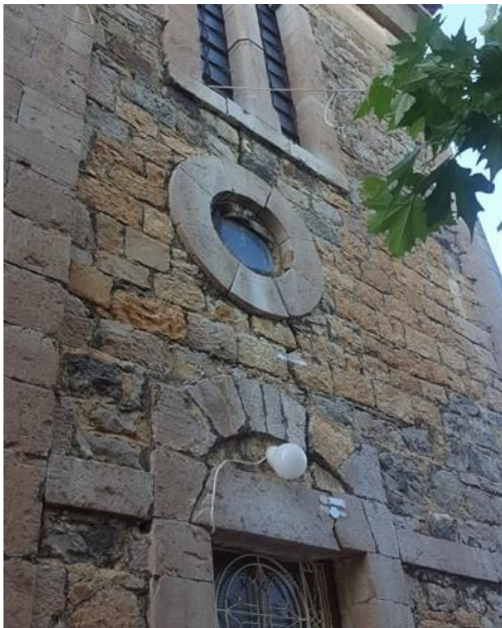
Εικόνα 3: Ρηγμάτωση τοιχοποιίας Ι.Ν.
