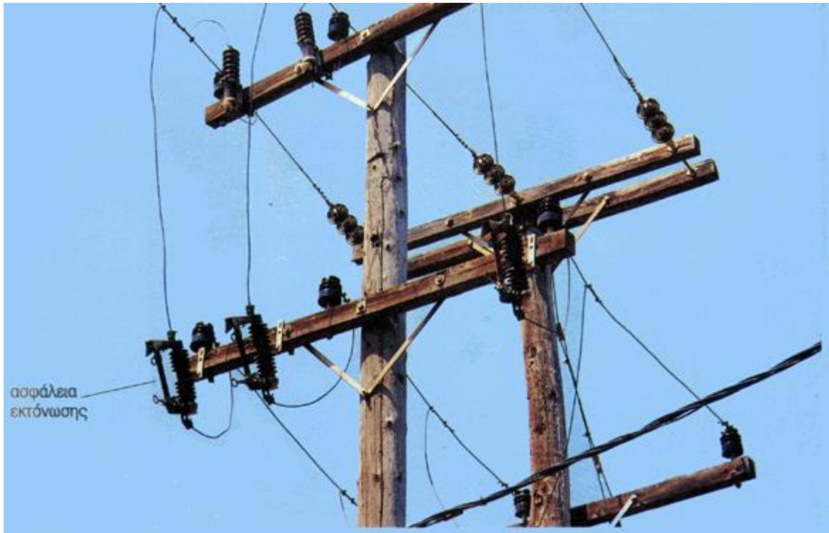
Εικόνα 4.7 Ασφάλεια εκτόνωσης πάνω σε στύλο Μ.Τ.
