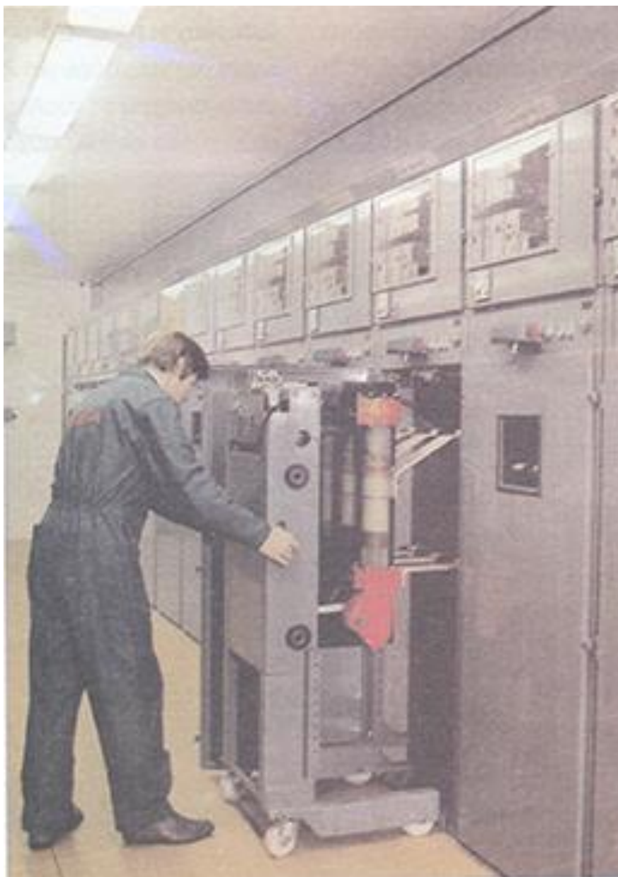
Εικόνα 4.13 Διακόπτης ισχύος επί φορείου
