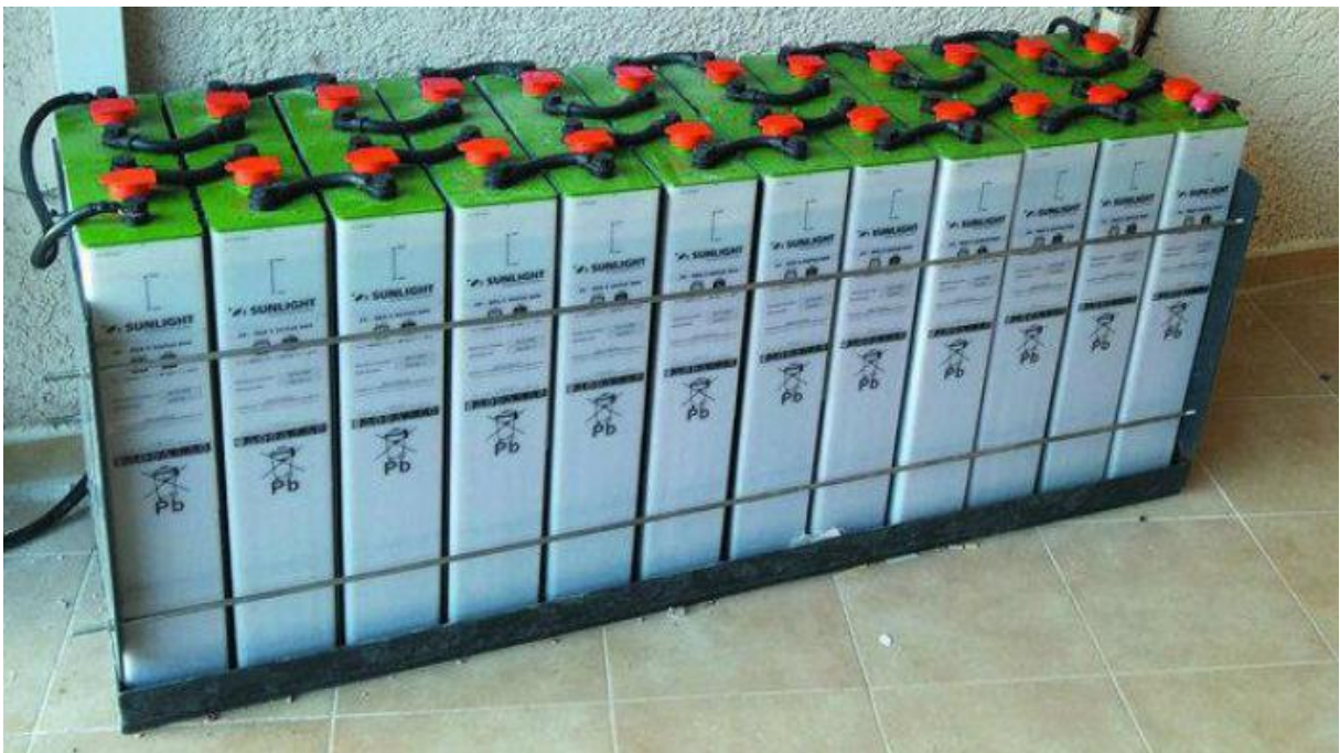
Εικόνα3.1 Συστοιχία συσσωρευτών φωτοβολταϊκού συστήματος
