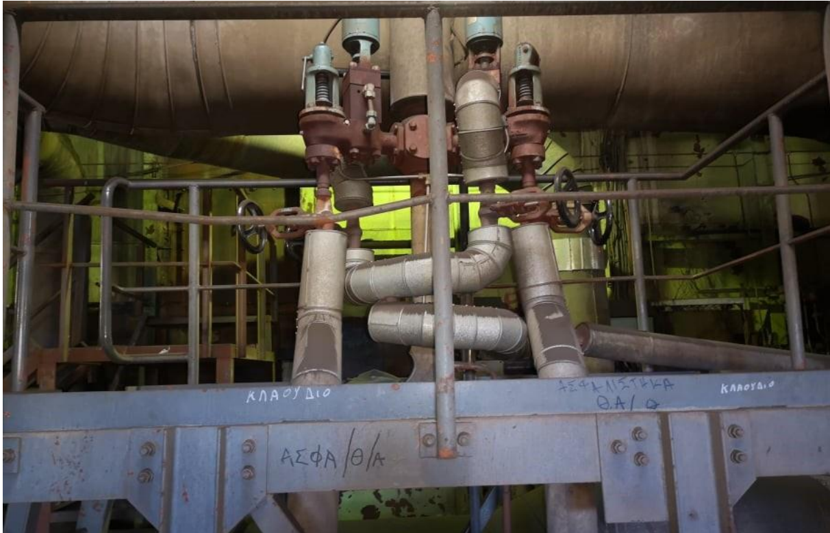
Εικόνα 4: Ασφαλιστικά θερμού αναθέρμου (Πηγή: ΜΟΝΑΔΑ ΙΙΙ ΜΕΓΑΛΟΠΟΛΗΣ )
