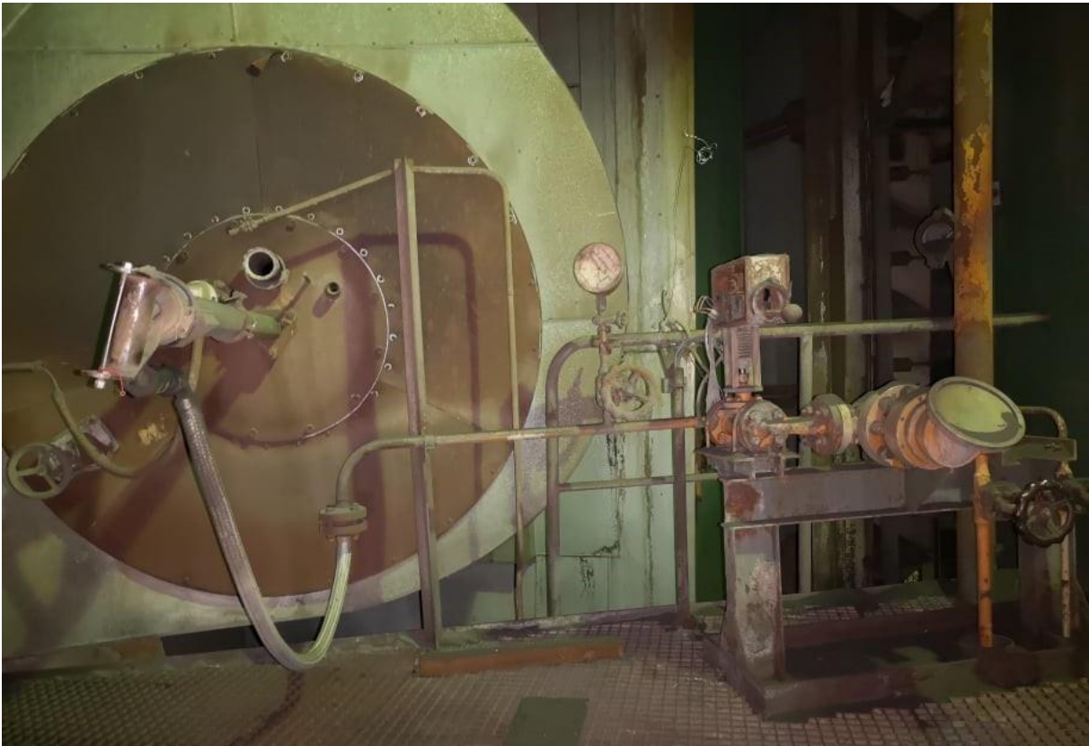
Εικόνα 15: Σύστημα καυστήρα πετρελαίου Νο 34 (Πηγή: ΜΟΝΑΔΑ ΙΙΙ ΜΕΓΑΛΟΠΟΛΗΣ )
