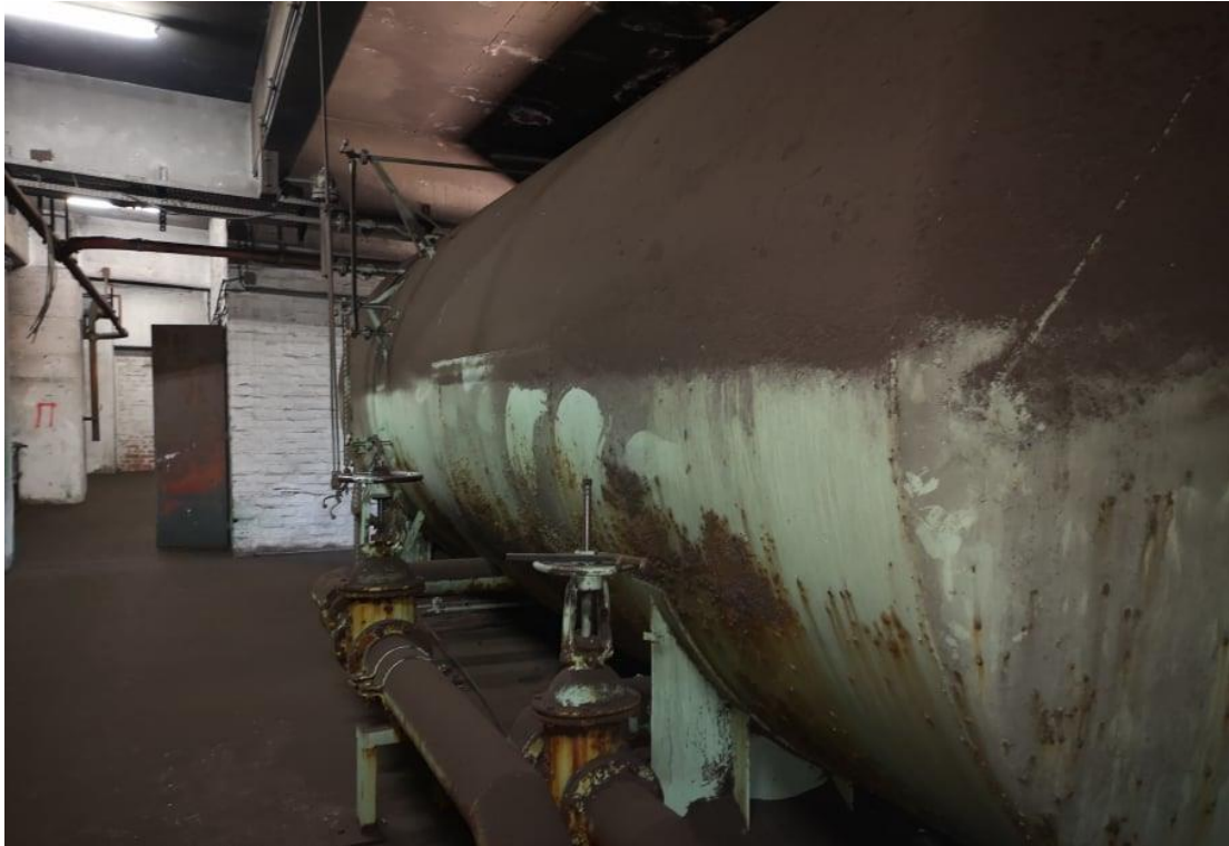
Εικόνα 28: Δεξαμενή 80 m 3 (Πηγή: ΜΟΝΑΔΑ ΙΙΙ ΜΕΓΑΛΟΠΟΛΗΣ )
