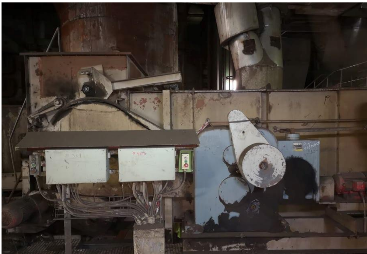
Εικόνα 8: P.I.V. τροφοδότη (Πηγή: ΜΟΝΑΔΑ ΙΙΙ ΜΕΓΑΛΟΠΟΛΗΣ )
