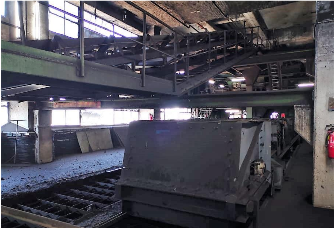
Εικόνα 6: Σύστημα τροφοδοσίας σιλό λιγνίτη (Πηγή: ΜΟΝΑΔΑ ΙΙΙ ΜΕΓΑΛΟΠΟΛΗΣ )
