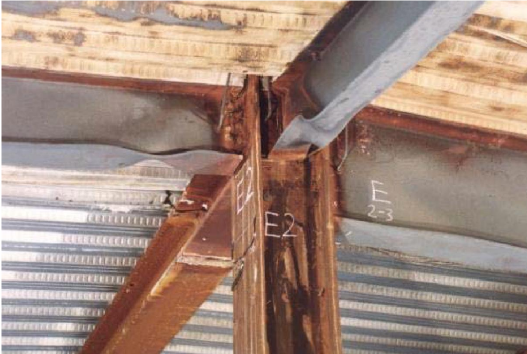
Εικόνα 3.4 Αστοχία μεταλλικών δοκών στην περιοχή της στήριξης λόγω τοπικού λυγισμού (Ε.Μ.Π.)
