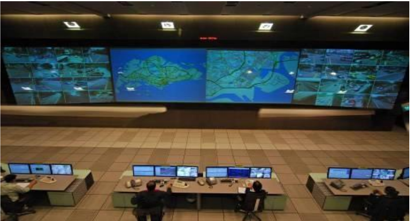
Εικόνα 7: Κέντρο Παρακολούθησης κυκλοφορίας στη Σιγκαπούρη (Πηγή: ITIF, 2010)
