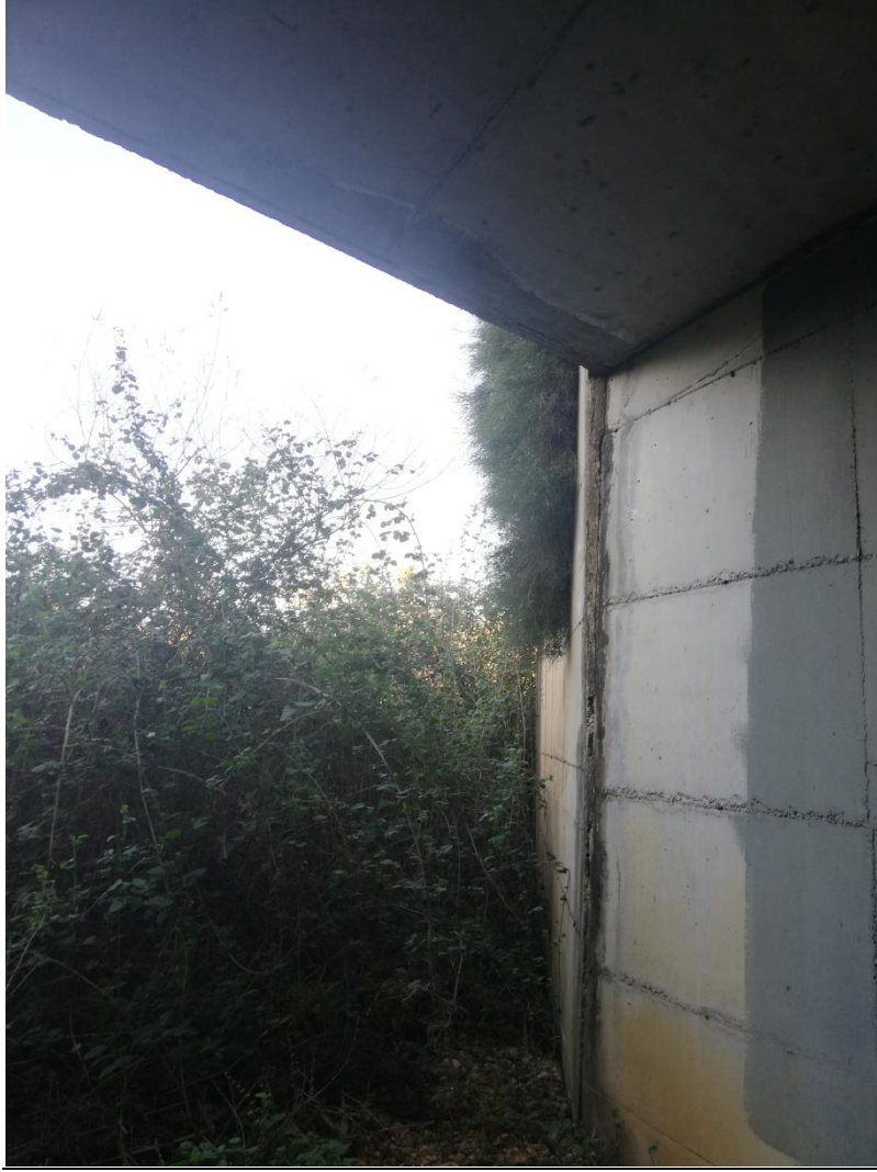
Εικόνα 5.6 Τοίχος Αντιστηρίξεως αριστερής όψης
