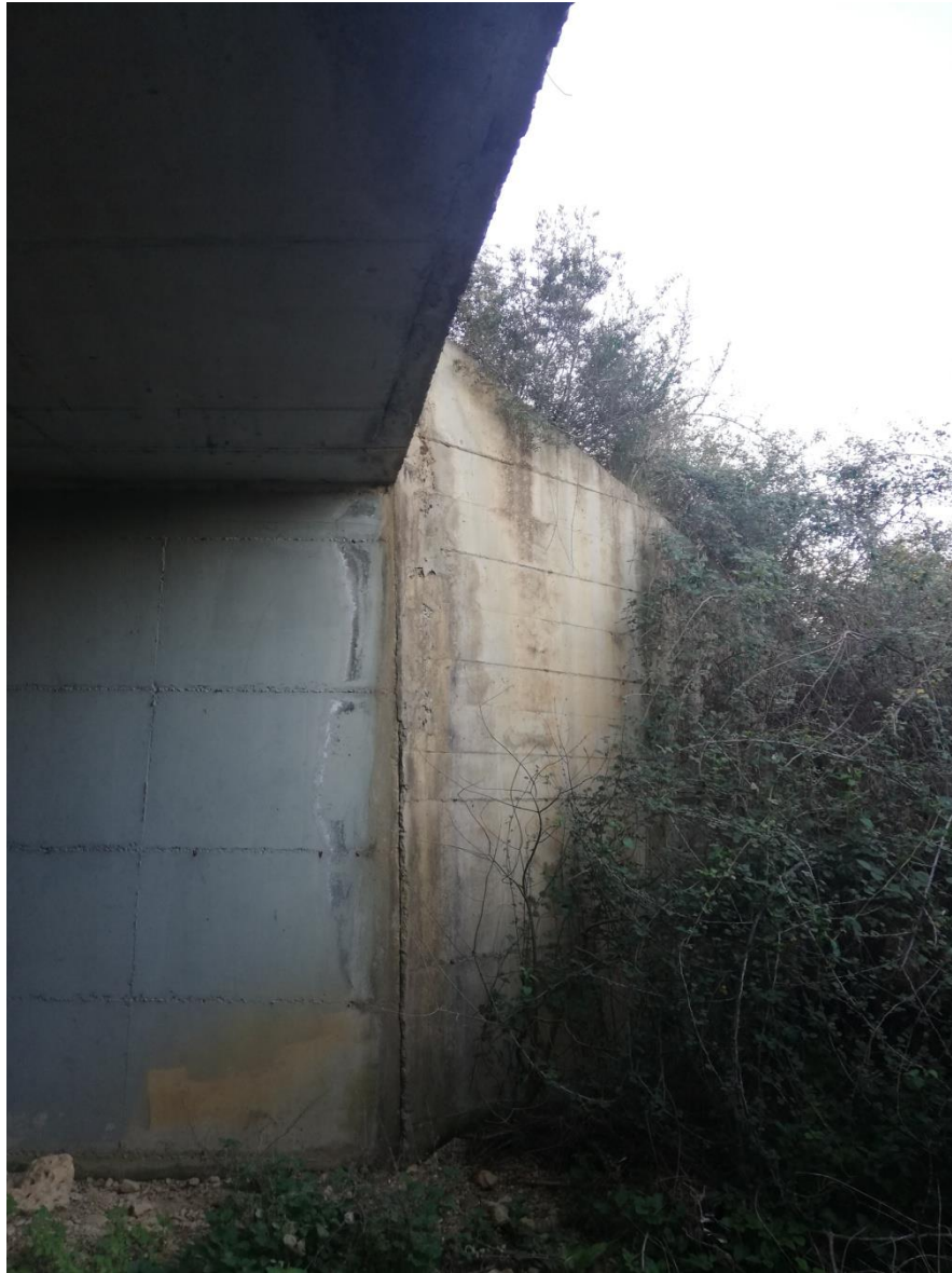
Εικόνα 5.5 Τοίχος Αντιστηρίξεως αριστερής όψης
