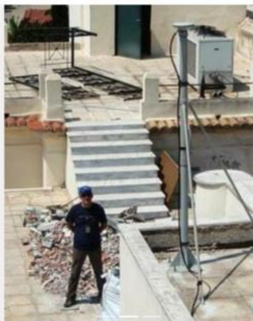
Εικόνα 89: Ο εξοπλισμός στον σταθμό «Pylo» στην Μεσσηνία (Πηγή: http://geodesy.gein.noa.gr:8000/nginfo/pylo/ , Πρόσβαση: 04 Απριλίου, 2020).
