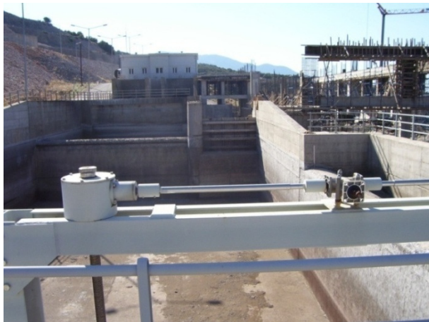
Εικόνα 67: Ο υπερχειλιστής ασφαλείας 12,8 m του καπάντη θαλάμου της λεκάνης ηρεμίας και ο θάλαμος φόρτισης.
