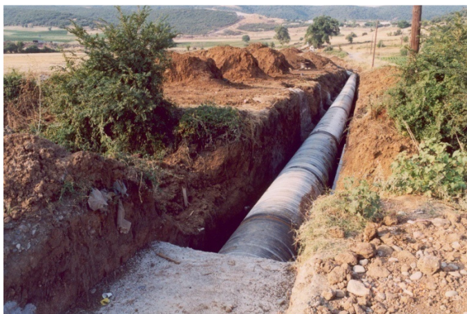
Εικόνα 105: Τροφοδοτικός αγωγός Φ 1200 mm.
