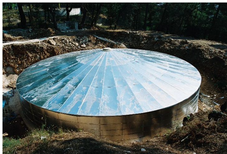
Εικόνα 40. Περιμετρική πλήρωση του κενού χώρου με τα περσευόμενα υλικά εκσκαφής απευθείας επί του σώματος της δεξαμενής
