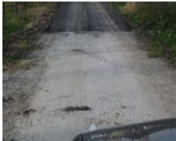
Εικόνα 2.21 - Ίχνη της οριακής διάρρηξης των εδαφικών υποχωρήσεων (σε δρόμο) στην περιοχή Βαλτόνερα.
