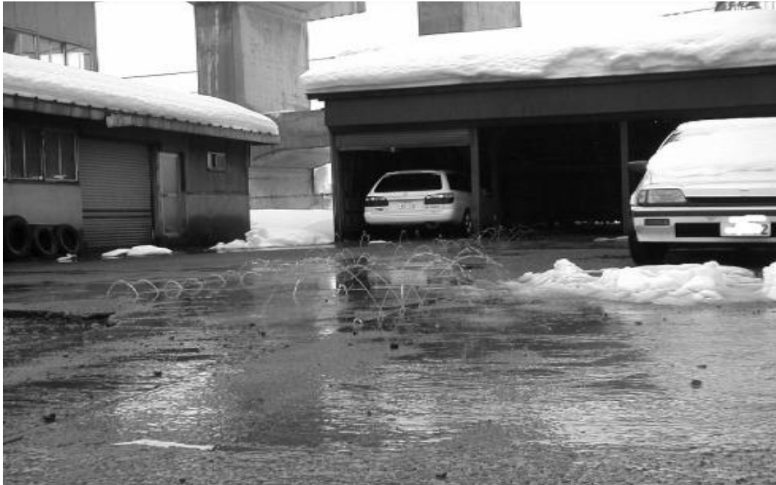
Εικόνα 2.43 - Εδαφικές διαρρήξεις σε οδόστρωμα στην πόλη Οjiya, Νιγκάτα, Ιαπωνία.
