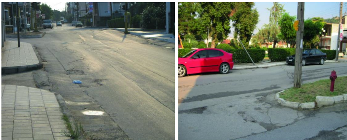
Εικόνα 2.31 - Ίχνη της οριακής διάρρηξης των εδαφικών υποχωρήσεων στην περιοχή των Φαρσάλων.
