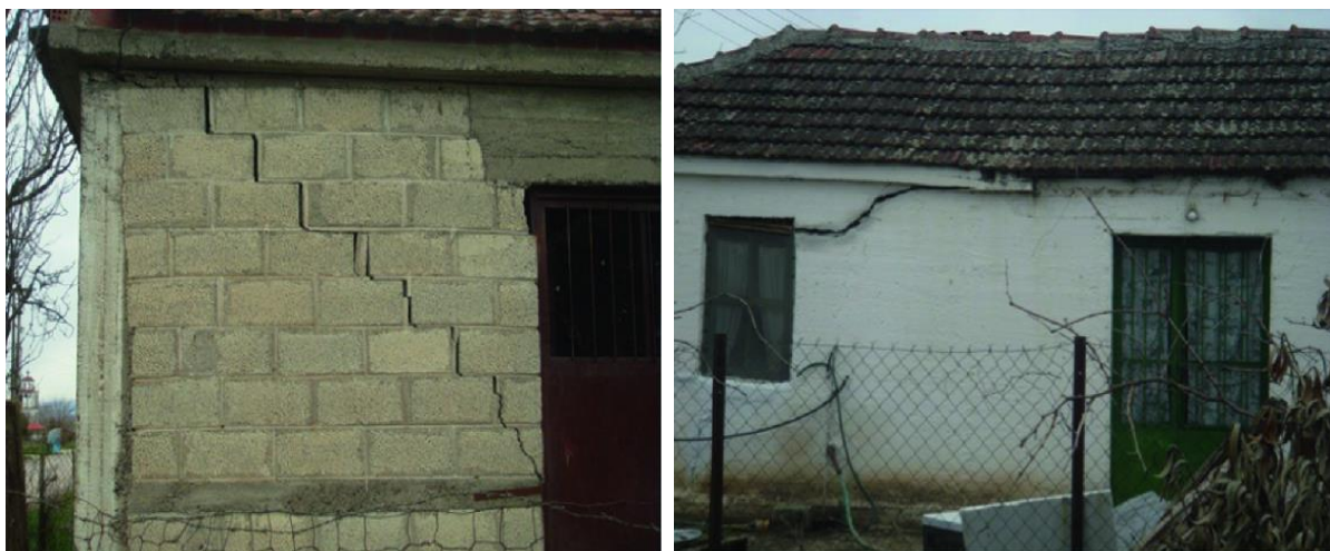
Εικόνα 2.29 - Ίχνη της οριακής διάρρηξης των εδαφικών υποχωρήσεων στο οικισμό του Αγίου Γεωργίου.
