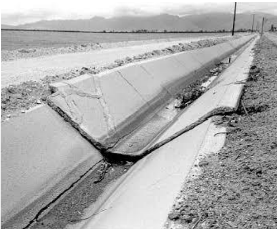
Εικόνα 2.4 - Εδαφικές διαρρήξεις σε περιοχή της Αριζόνας.
