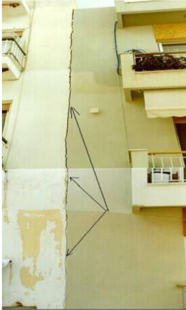
Εικόνα 2.66 - Αποψη διευρυνόμενης ρωγμής στην επαφή δύο διώροφων οικοδομών.
