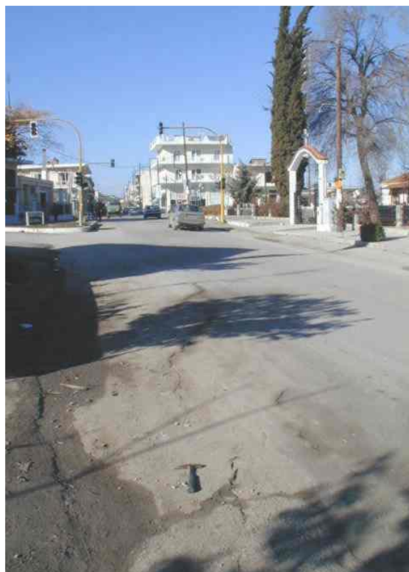
Εικόνα 2.33 - Εμφανή ίχνη της οριακής διάρρηξης των εδαφικών υποχωρήσεων στην περιοχή των Φαρσάλων, σε δρόμο.
