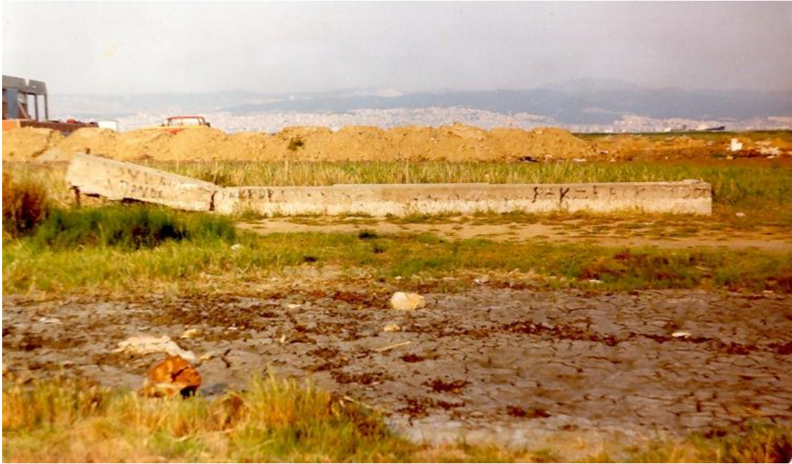
ΕΙΚΟΝΑ 2.18 - Η ανύψωση τμήματος ποτίστρας και η αποκοπή του από το υπόλοιπο τμήμα λόγω των εδαφικών υποχωρήσεων στην περιοχή Καλοχωρίου Θεσσαλονίκης.
