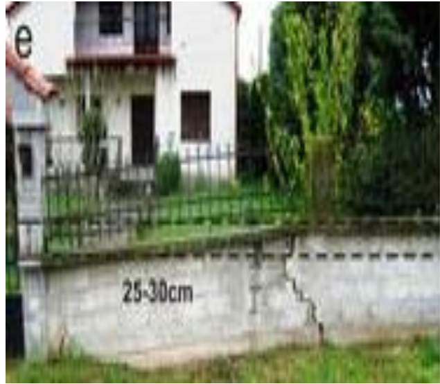
Εικόνα 2.24 - Ίχνη της οριακής διάρρηξης των εδαφικών υποχωρήσεων (αστοχία κτιρίου) στην περιοχή Βαλτόνερα.
