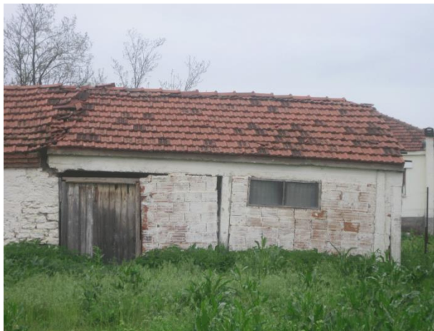
Εικόνα 2.20 - Ίχνη της οριακής διάρρηξης των εδαφικών υποχωρήσεων (αστοχία κτιρίου) στην περιοχή Βαλτόνερα.
