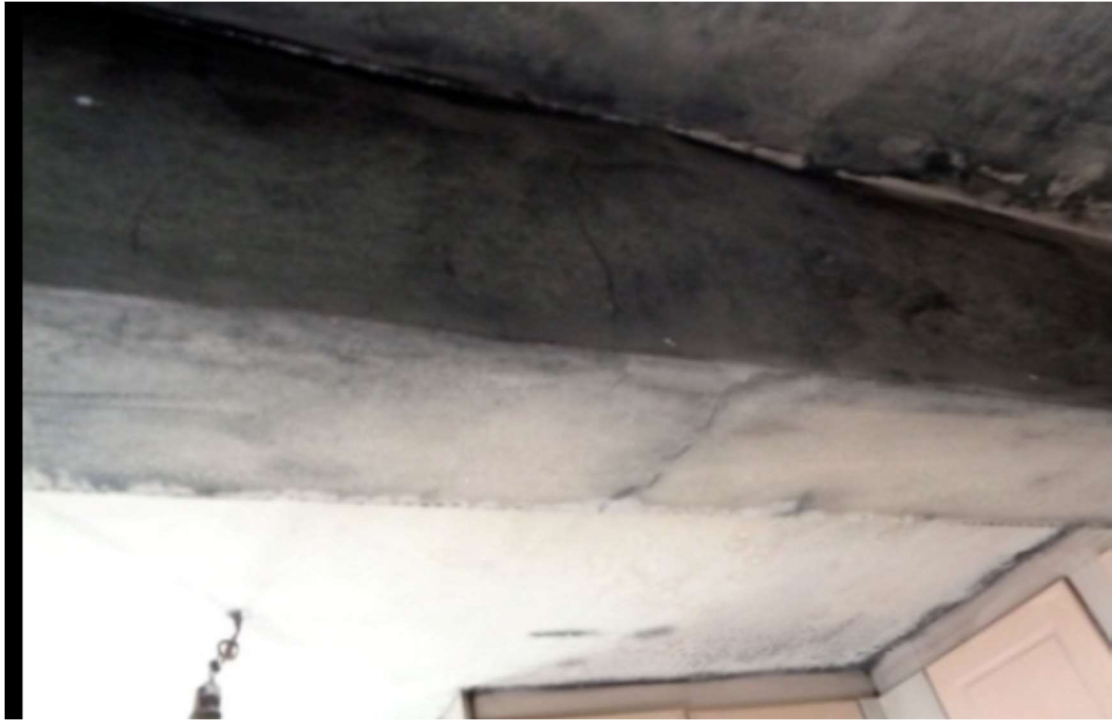
Εικόνα 2. Βλάβες από πυρκαγιά (Assessing Structural Damage after a Severe Wildfire: A Case Study ,Angeliki Papalou * and Dimitrios K. Baros)
