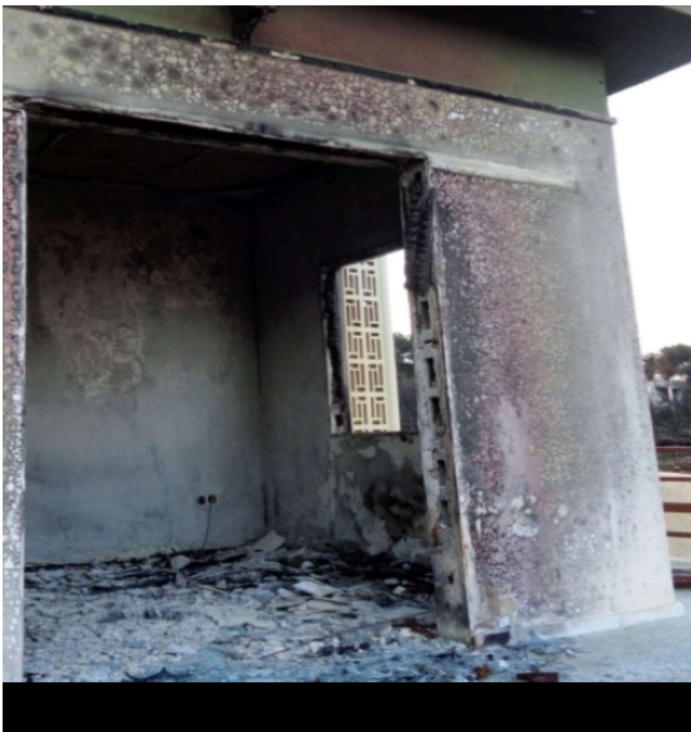
Εικόνα 1. Βλάβες από πυρκαγιά (Assessing Structural Damage after a Severe Wildfire: A Case Study ,Angeliki Papalou * and Dimitrios K. Baros)
