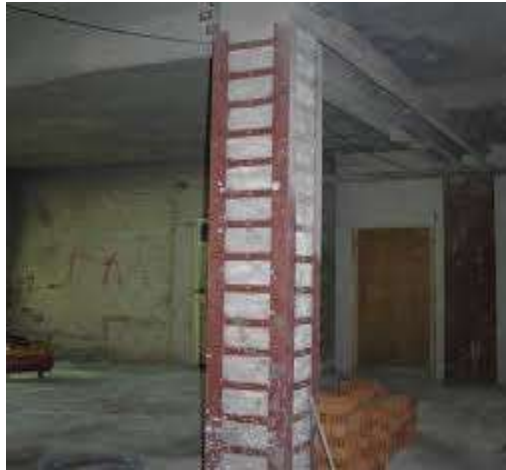
Εικόνα 15. Ενίσχυση σύλου με τη μέθοδο του μεταλλικού κλωβού(Διερεύνηση απόδοσης με κριτήρια βιωσιμότητας της ενίσχυσης υφιστάμενων κτιρίων οπλισμένου σκυροδέματος με την εισαγωγή συστημάτων χαλύβδινων και σύμμικτων στοιχείων. Κουκούλη Ναταλία Μαλιώκας Αρσένιος)
