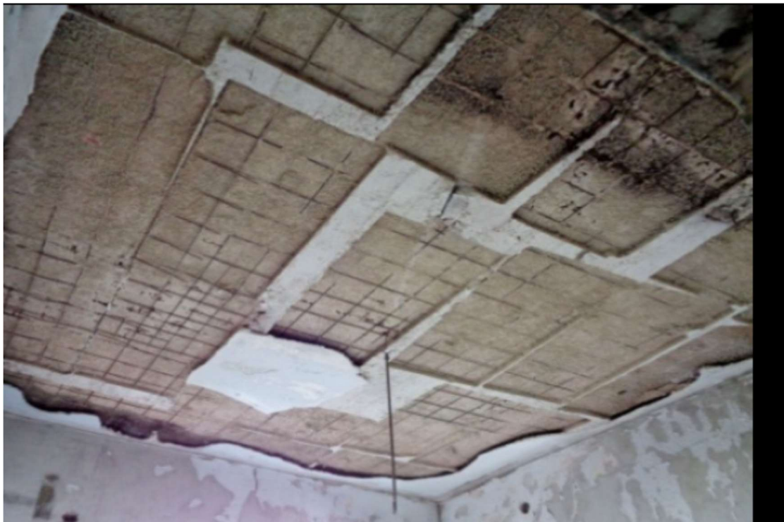
Εικόνα 3. Βλάβες από πυρκαγιά (Assessing Structural Damage after a Severe Wildfire: A Case Study ,Angeliki Papalou * and Dimitrios K. Baros)
