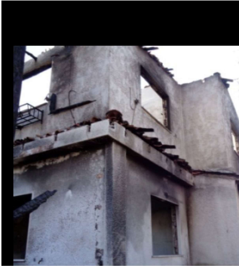
Εικόνα 4. Βλάβες από πυρκαγιά (Assessing Structural Damage after a Severe Wildfire: A Case Study ,Angeliki Papalou * and Dimitrios K. Baros)
