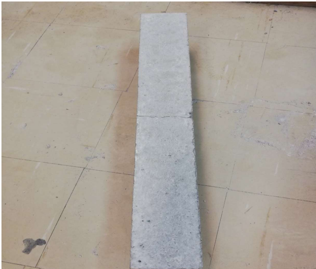
Εικόνα 46. Ρωγμές αστοχίας δοκιμίου 1 μετά την δοκιμή της κάμψης.
