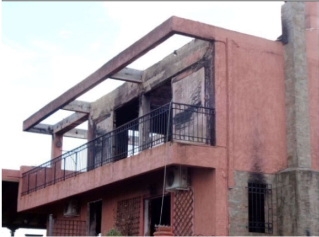
Εικόνα 6. Βλάβες από πυρκαγιά (Assessing Structural Damage after a Severe Wildfire: A Case Study ,Angeliki Papalou * and Dimitrios K. Baros)
