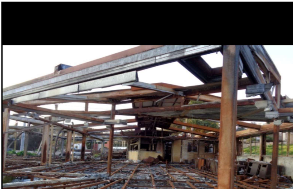
Εικόνα 5. Βλάβες από πυρκαγιά (Assessing Structural Damage after a Severe Wildfire: A Case Study ,Angeliki Papalou * and Dimitrios K. Baros)
