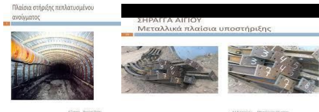
Εικόνα 2.11 μεταλλικά πλαίσια-αγωγός εξαερισμού
