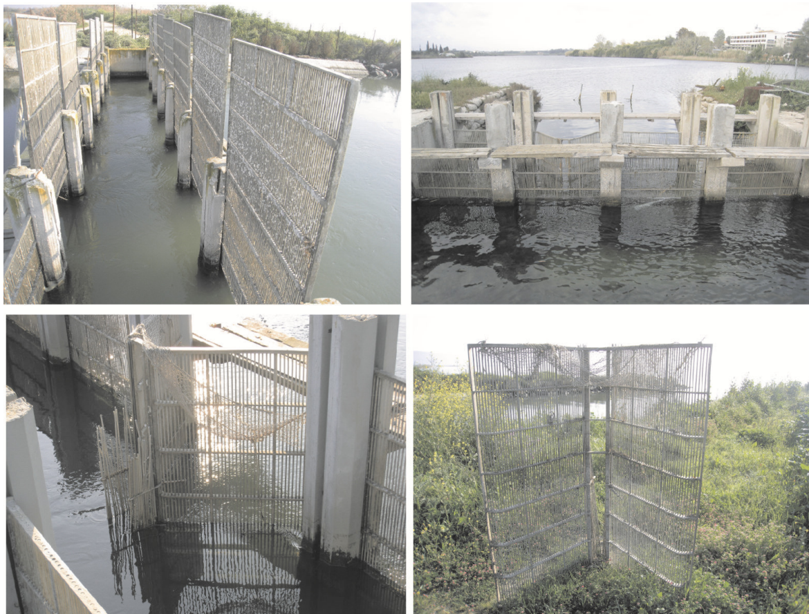
Εικόνα 1. Οι ιχθυοσυλληπτικές εγκαταστάσεις όπου διακρίνονται: (α-β) οι δρομίδες και (γ-δ) οι πείρες μέσα και έξω από το νερό.
