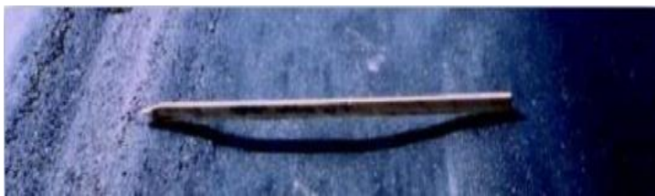
Εικόνα 6: Μόνιμη παραμόρφωση επιφανειακής στρώσης.
