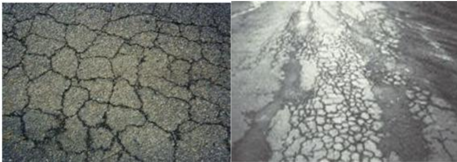
Εικόνα 4: Ρωγμές τύπου αλιγάτορα.
