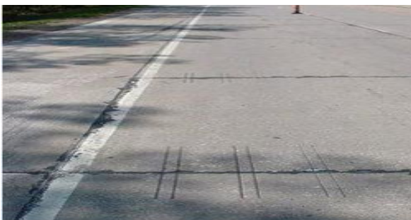
Εικόνα 5: Διαμήκεις και εγκάρσιες ρωγμές.
