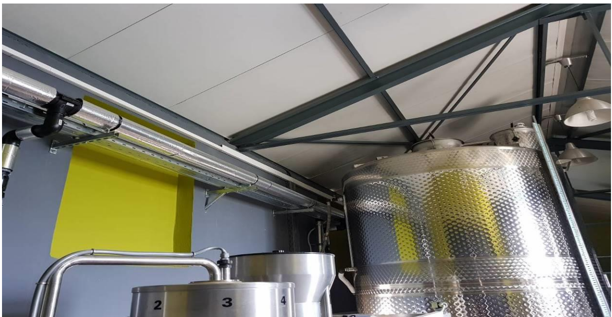
Εικόνα 3-12: Σωλήνες μεταφοράς του ψυκτικού υγρού στις δεξαμενές
