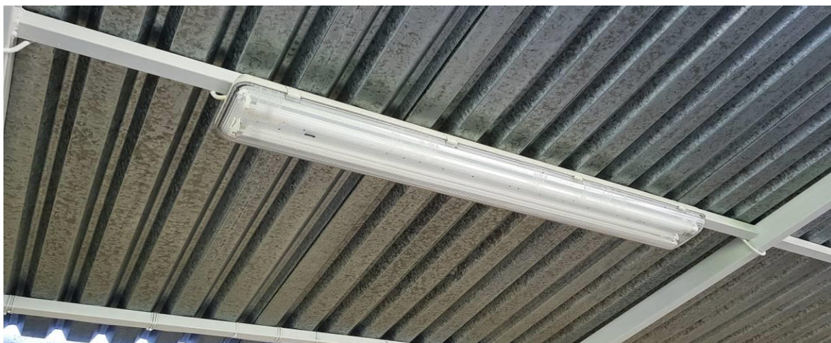
Εικόνα 3-2: Φώτα Φθορίου (στέγαστρο)
