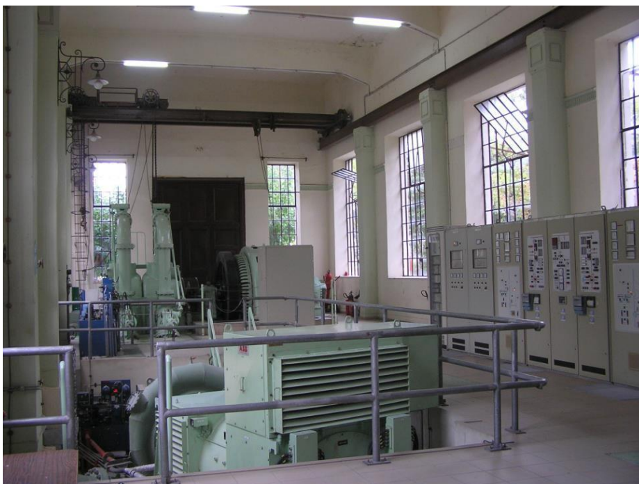
Εικόνα 4.12: Εσωτερική άποψη σταθμού. Στα δεξιά της φωτογραφίας ο πίνακας ελέγχου και στο βάθος ο στρόβιλος Pelton.
