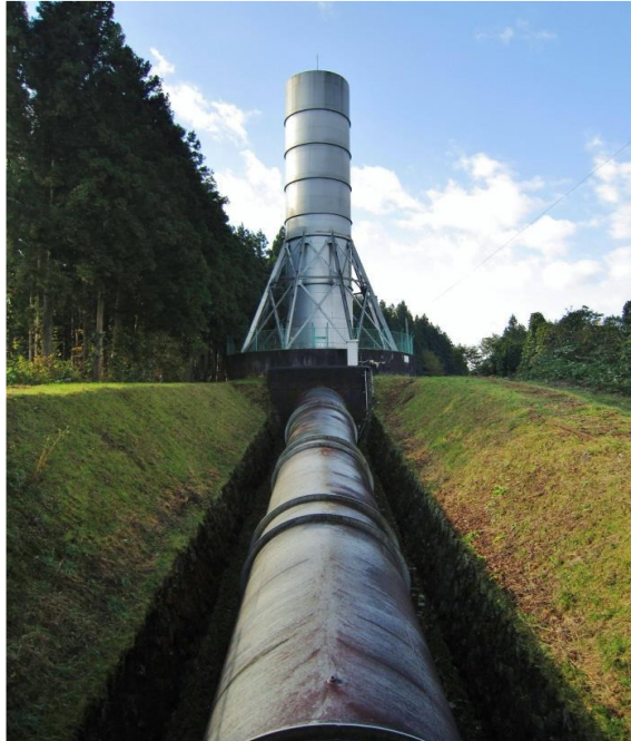
Εικόνα 3.21: Αγωγός πτώσης και πύργος ανάπασης ΥΗΣ Isawa (Ιαπωνία).
