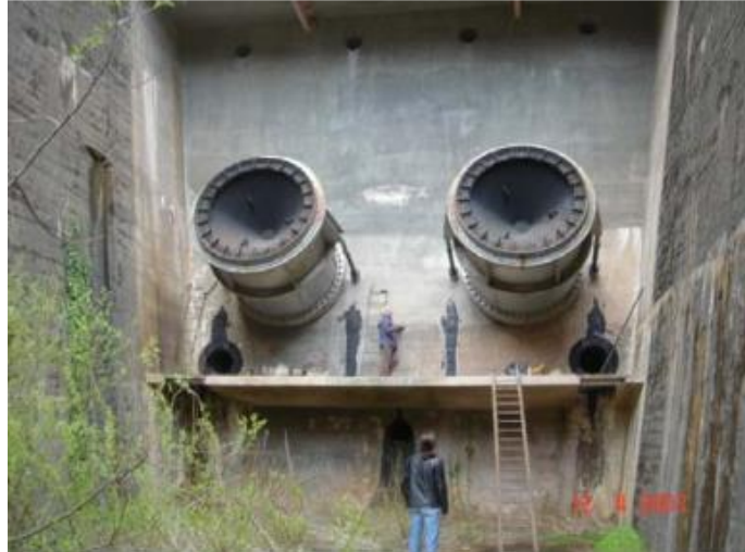
Εικόνα 3.17: Έξοδος εκκενωτή φράγματος Ταυρωπού.
