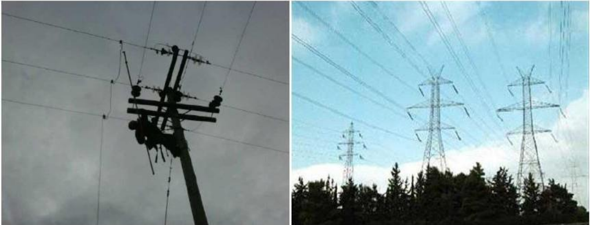
Εικόνα 4.19: Κολώνα μέσης τάσης (αριστερά) και πυλώνες υψηλής τάσης.
