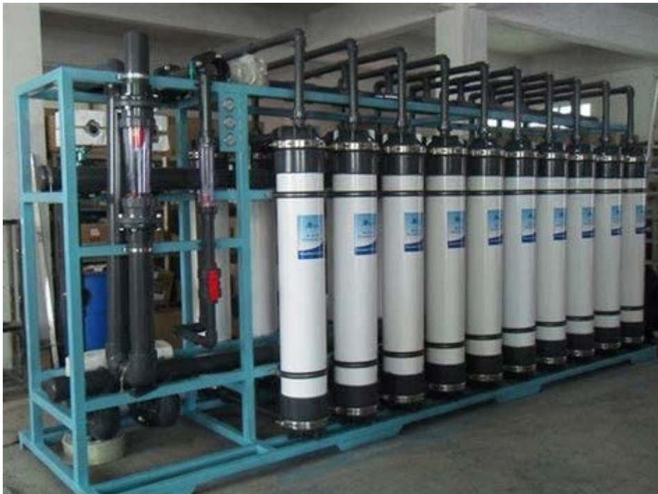
Εικόνα 15: Εγκατάσταση αφαλάτωσης αντίστροφης όσμωσης
