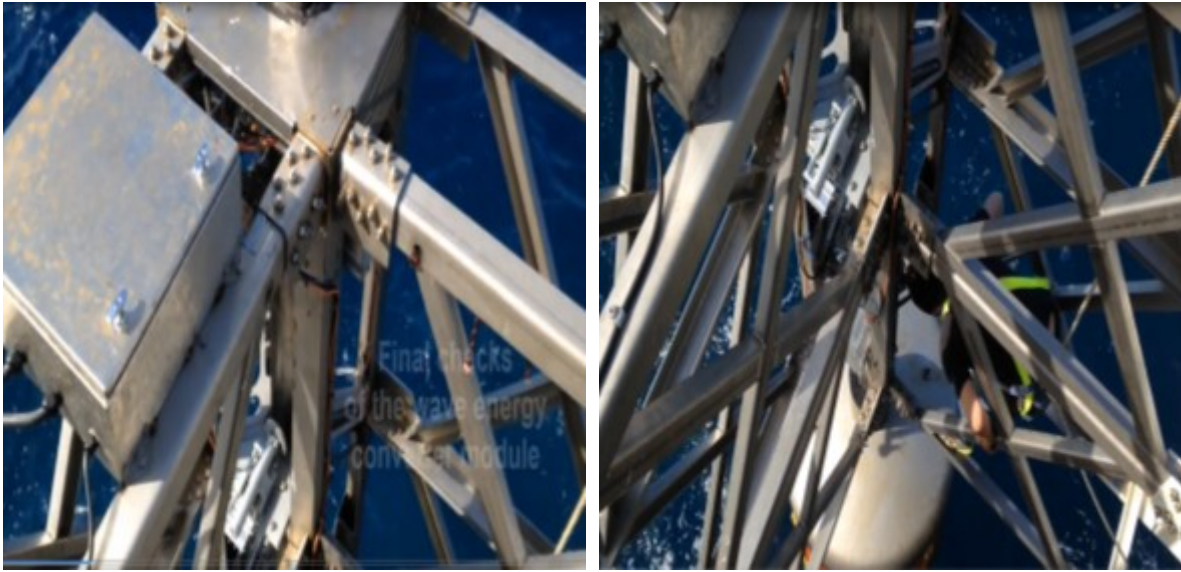
Εικόνα 104: Το δομοστοιχείο εγκατεστημένο - Ηλεκτρομηχανολογικός εξοπλισμός (on board).
