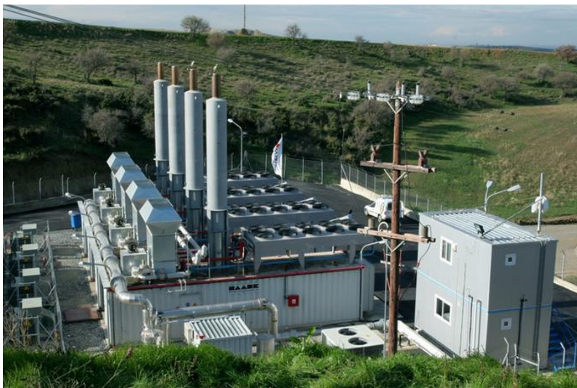
Εικόνα 2.1 Μονάδα παραγωγής βιοαερίου στον ΧΥΤΑ Ταγαράδων στη Θεσσαλονίκη [16].
