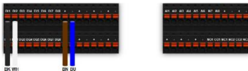
Εικόνα 4.3.4.2 Σύνδεση ακροδεκτών αισθητήρα στην διεπαφή I/O του ρομπότ [28].
