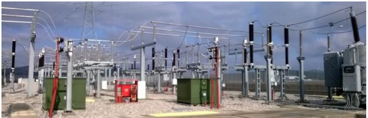
Εικόνα 2.1: Υποσταθμοί καταναλωτή Μέσης Τάσης
