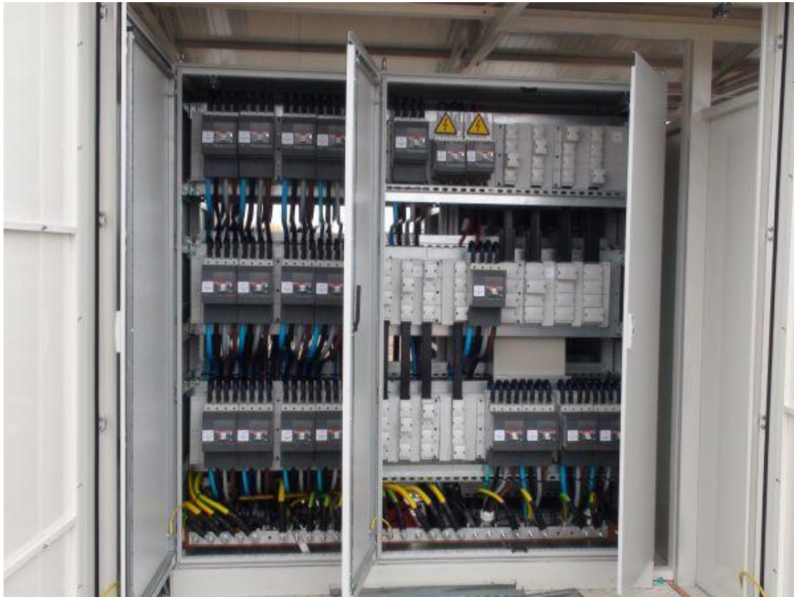
Εικόνα 2.4: Πίνακας Χαμηλής Τάσης
