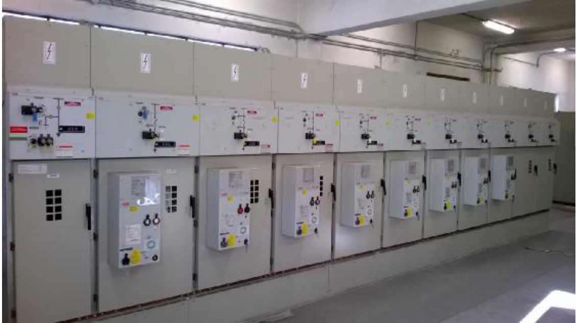
Εικόνα 2.2: Πεδία Μέσης Τάσης
