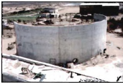
Κυκλική δεξαμενή αποθήκευσης αφαλατωμένου νερού
