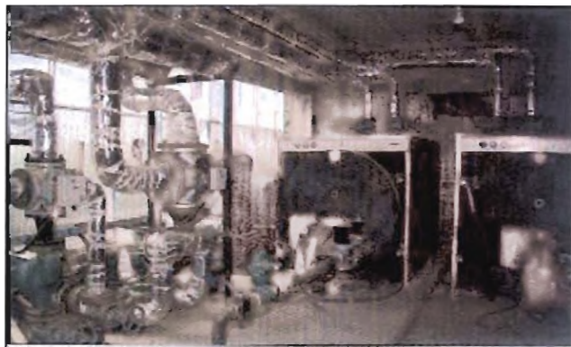
Εικόνα 4. Λεβητοστάσιο με κεντρικό σύστημα θέρμανσης με θερμό νερό.
