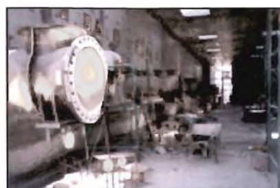
Σωλήνες φιλτραρισμένου νερού
