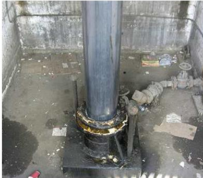
Εικόνα 22: Μεταλλικός σωλήνας τροφοδοσίας.
