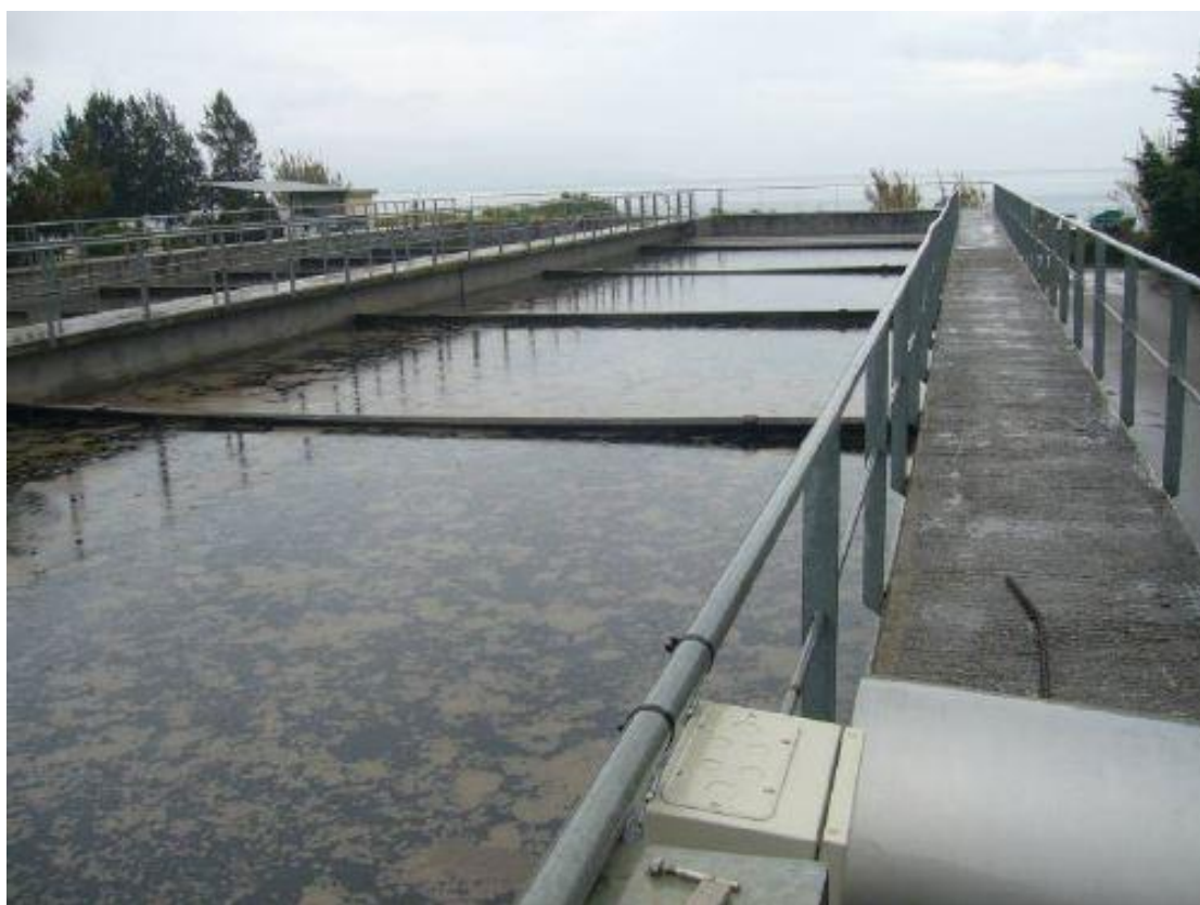
Εικόνα 19. Δεξαμενή καθίζησης ΕΕΛ Αιγίου.
