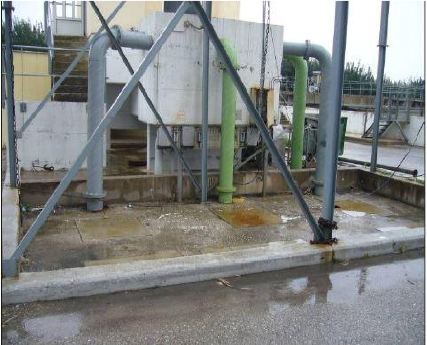
Εικόνα 6: Φρέατιο Αντλιοστασίου ΕΕΛ Αιγίου.
