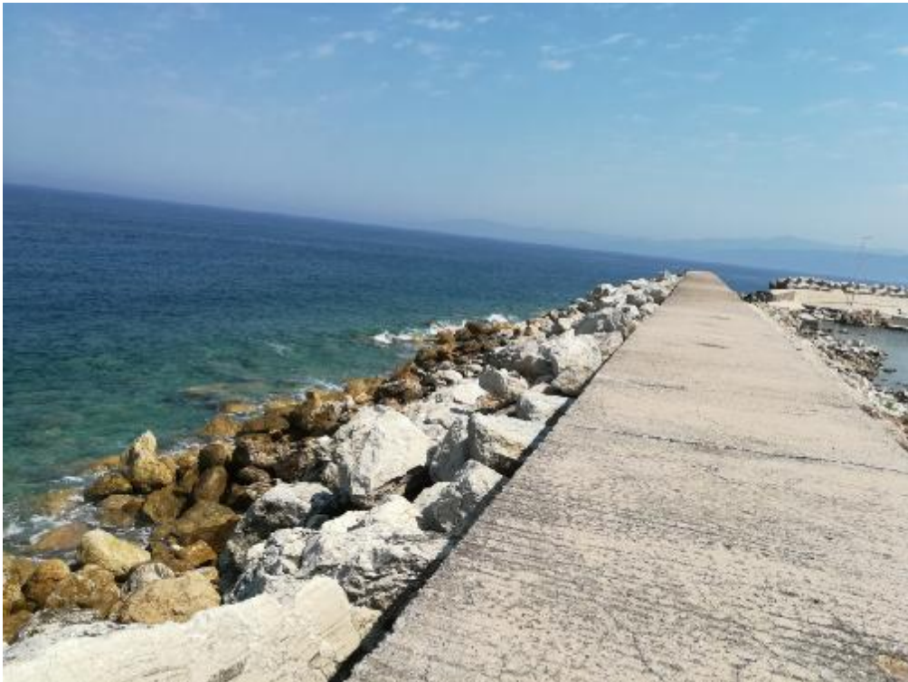
Εικόνα 10: Φωτογραφία προσήνεμου μόλου από την αρχή του προς τη πλευρά του πελάγους.
