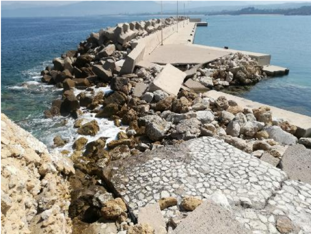
Εικόνα 13: Φωτογραφία η οποία έχει ληφθεί από ψηλά ακριβώς στο σημείο της επέκτασης του προσήνεμου μόλου όπου φαίνεται ακόμα καλύτερα η πτώση του προστατευτικού τοίχου και η θραύση του καταστρώματος.
