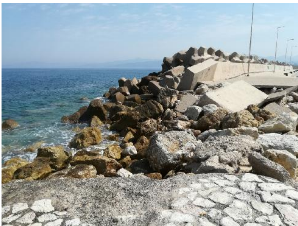
Εικόνα 7: Φωτογραφία ακριβώς στο σημείο της επέκτασης από τη πλευρά του πελάγους, όπου φαίνεται ακόμα καλύτερα η πτώση του προστατευτικού τοίχους.
