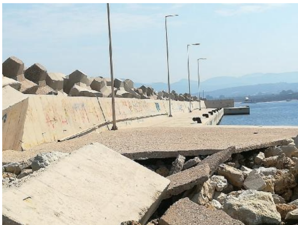
Εικόνα 8: Φωτογραφία στην οποία βλέπουμε την αρχή της επέκτασης του προσήνεμου μόλου καθώς και την θραύση του σε πολλά σημεία του προστατευτικού τοίχους και του καταστρώματος.
