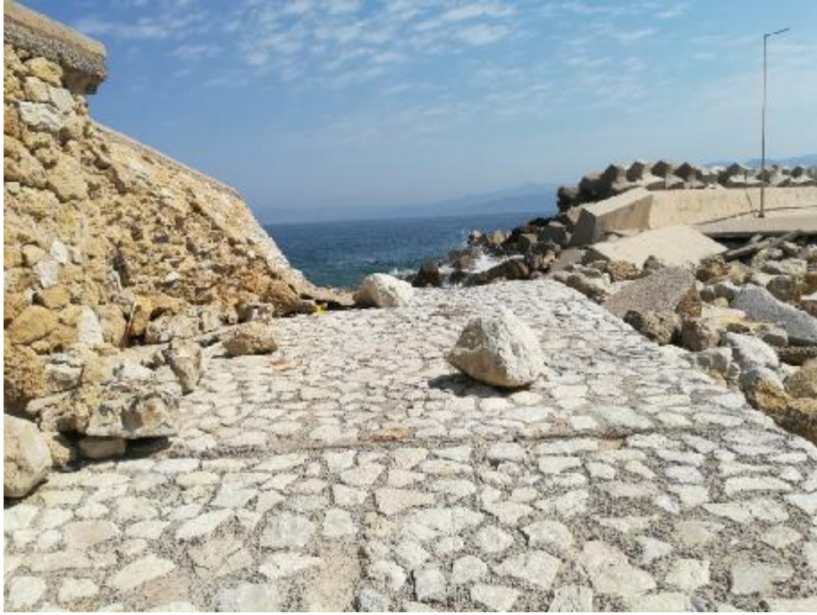
Εικόνα 5: Φωτογραφία στο τέλος του προσήνεμου μόλου λίγο πριν την πτώση του προστατευτικού τοίχους στο σημείο της επέκτασής του.
