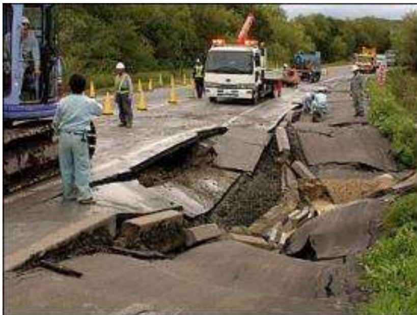
Εικ. 1 Ολίσθηση εδάφους λόγω ρευστοποίησης
