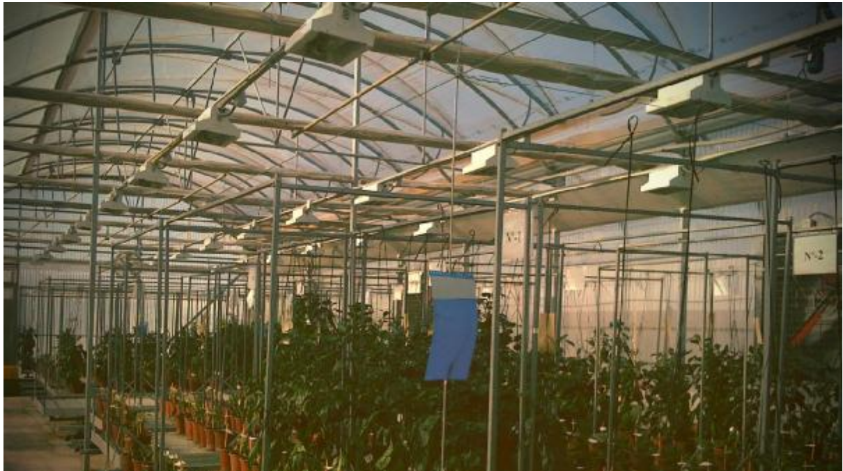
Εικόνα 6.Σύστημα φωτισμού σε θερμοκήπιο
