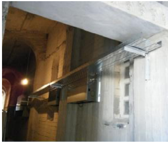
Φ.4 ΜΕΤΑΛΛΙΚΟ ΚΑΝΑΛΙ ΓΙΑ ΣΤΗΡΙΞΗ ΣΩΛΗΝΩΝ
