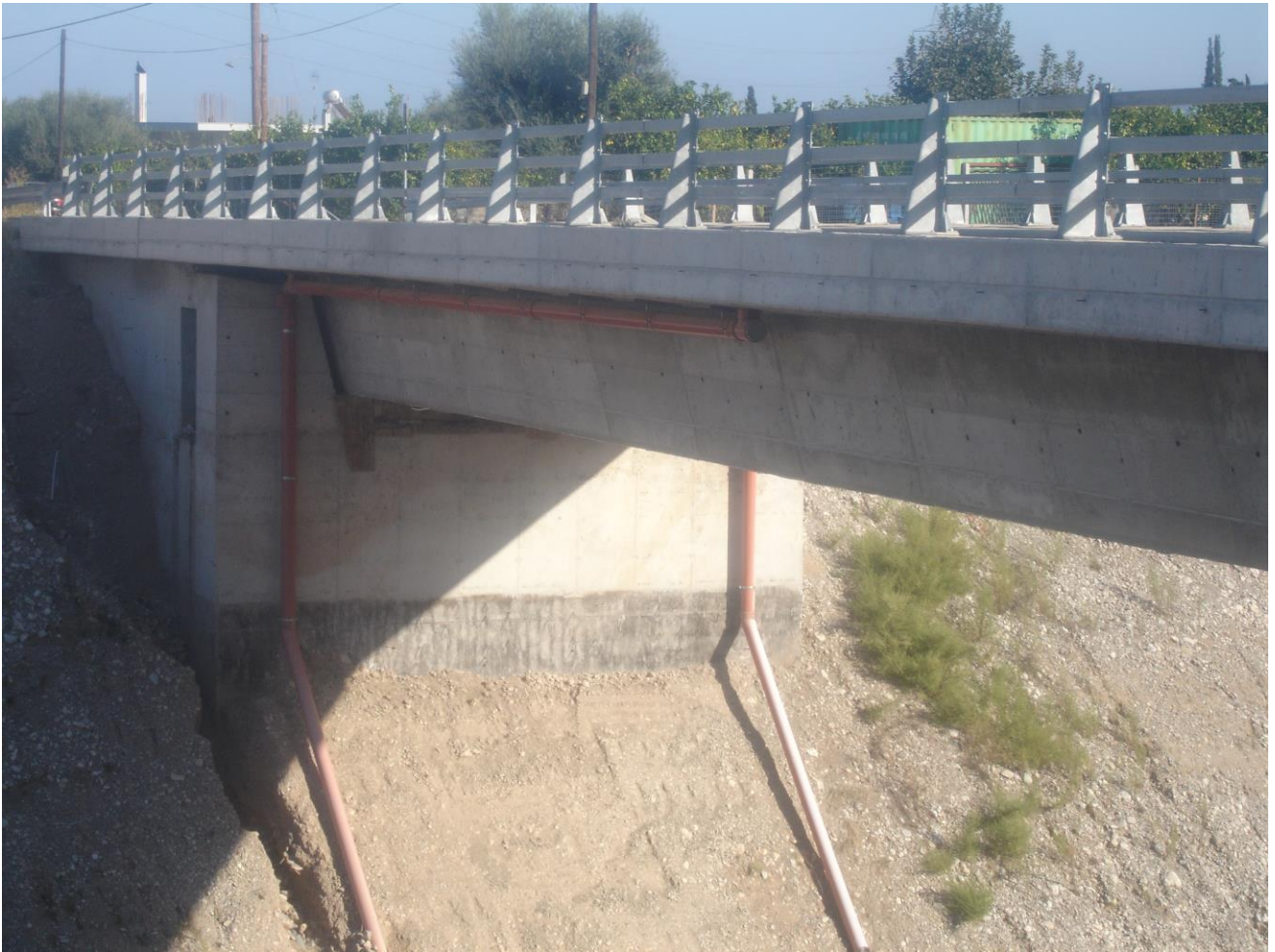
ΦΩΤΟΓΡΑΦΙΑ 4.3 : Φαίνονται οι αγωγοί όμβριων υδάτων βόρειας όψης καθώς και τα εφέδρανα εντός των καλουπιών.
