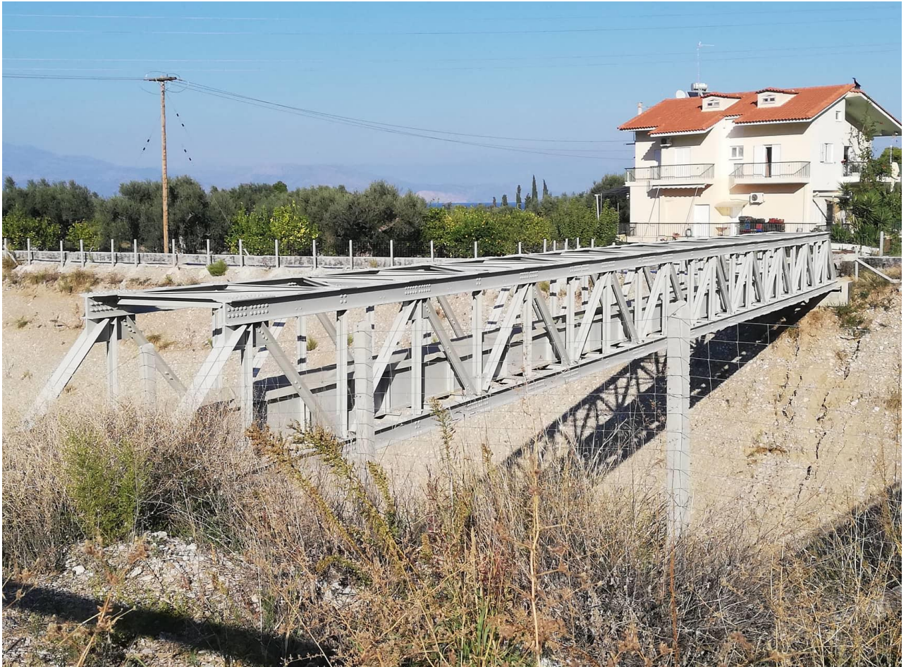
ΦΩΤΟΓΡΑΦΙΑ 4.12 : Διακρίνεται η μικρότερη γέφυρα του υδραγωγείου που βρίσκεται στη βόρεια όψη.
