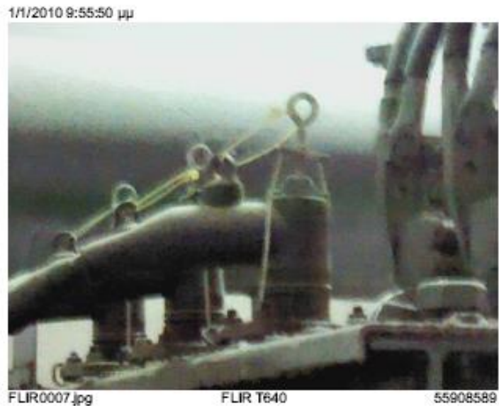
Εικόνα 68: Αυξημένη θερμοκρασία στο επάνω μέρος του Μ/Σ , η είσοδος του Μ/Σ 20kv και πίσω η αναχώρηση Χ.Τ. [8]
