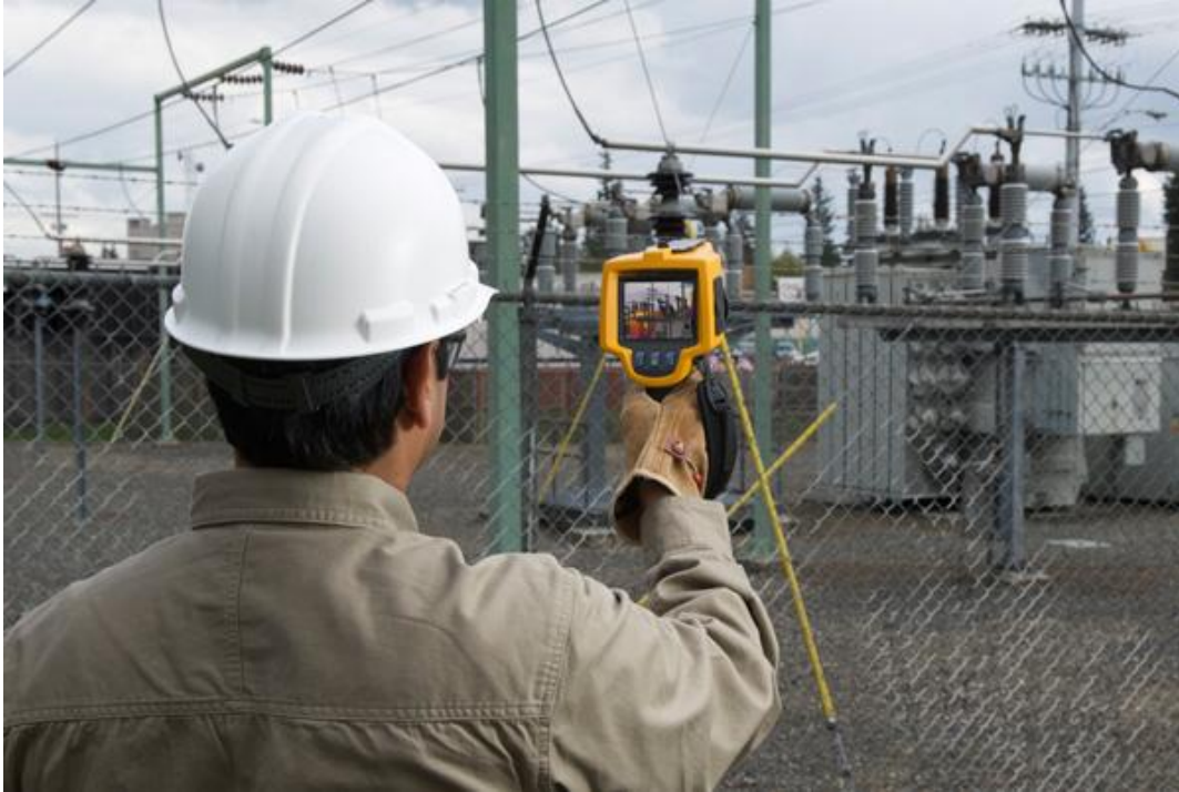
Εικόνα 11: Μέτρηση υποσταθμού με θερμοκάμερα [4]
