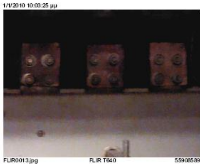
Εικόνα 71: Αυξημένη θερμοκρασία στην αναχώρηση Χ.Τ. από το διακόπτη φορτίου [8]
