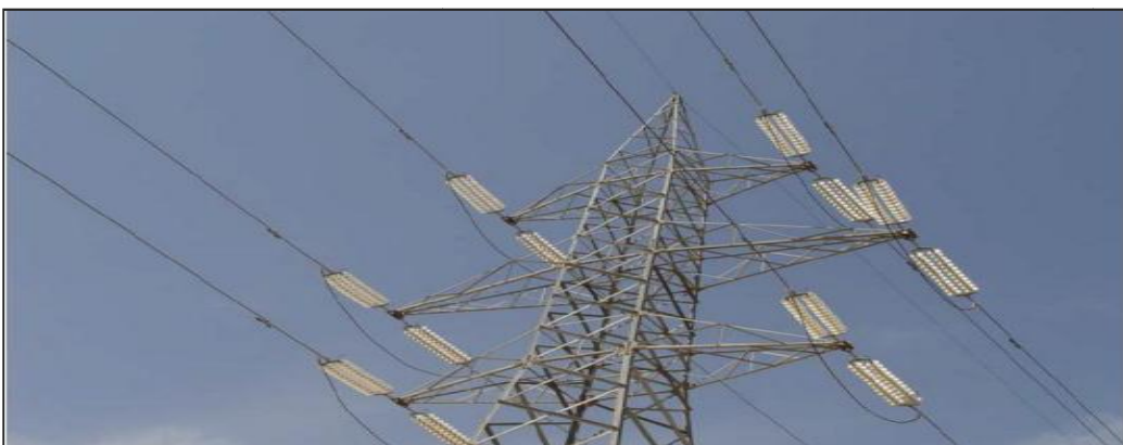
Εικόνα 15: Γυάλινοι μονωτήρες διέλευσης σε πυλώνες
