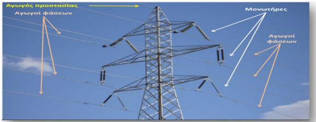
Εικόνα 3: Εναέρια Γραμμή Μεταφοράς
