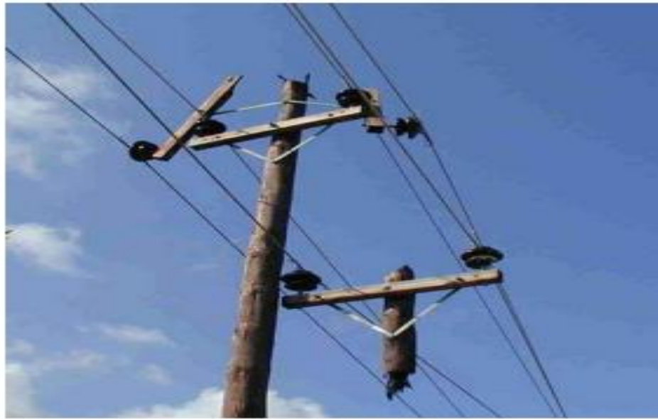
Εικόνα 40: Καταστροφή στύλου δικτύου διανομής 20kV από πυρκαγιά λόγω ρύπανσης
