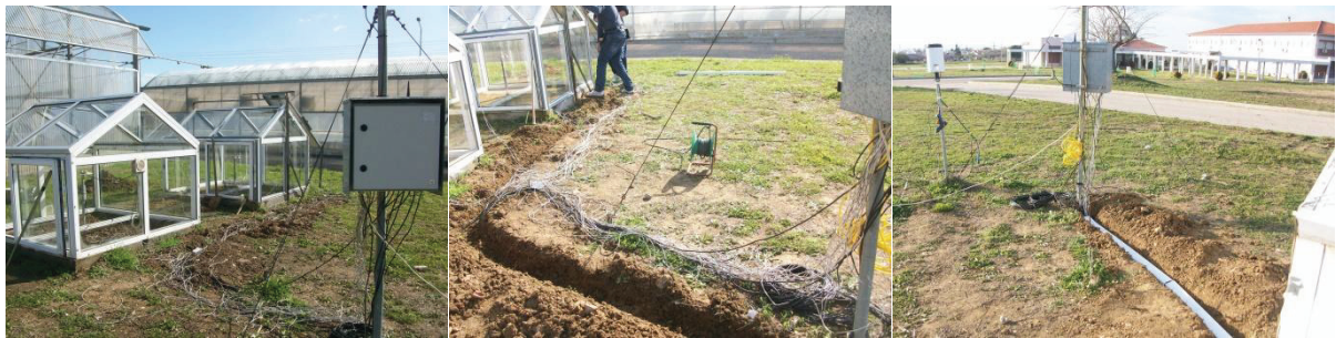
Εικόνα 4.4: Εγκατάσταση αισθητήρων και μετεωρολογικού σταθμού και συνδέσεων[58]
