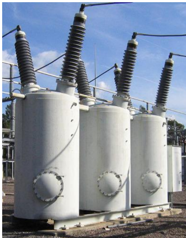
Εικόνα 4: Διακόπτες Ισχύος ελαίου
