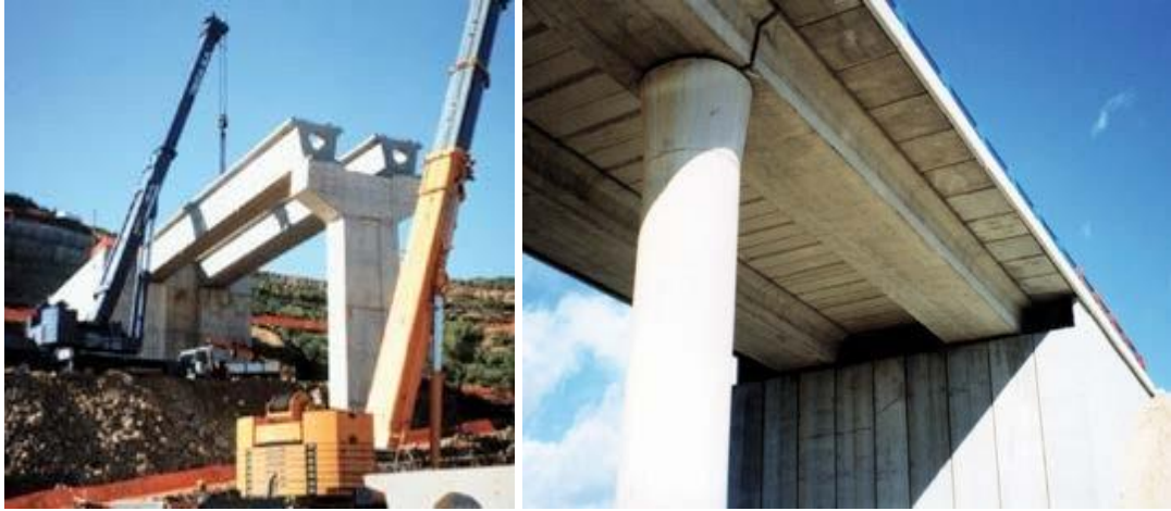
Εικ. 4.19: Ανέγερση γέφυρας διπλής λωρίδας κιβωτιοειδούς διατομής. (Πηγή: “PRECAST CONCRETE BRIDGES”, state-of-art-report, fib ceb-fip (bulletin 29))
