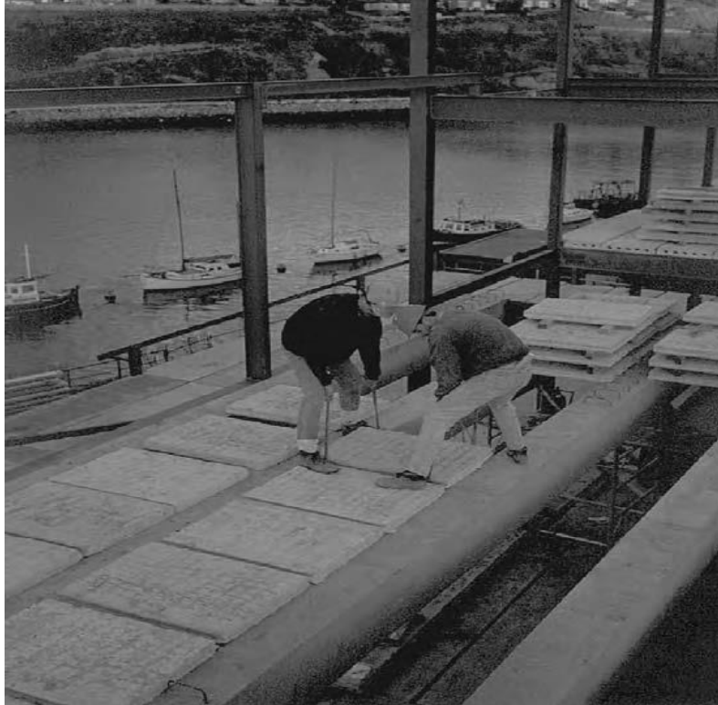
Εικ. 2.12: Σύνθεση δαπέδου από δοκό και πρόπλακα υπό κατασκευή, (Πηγή: “PRECAST CONCRETE STRUCTURES”, Kim S. Eliot)
