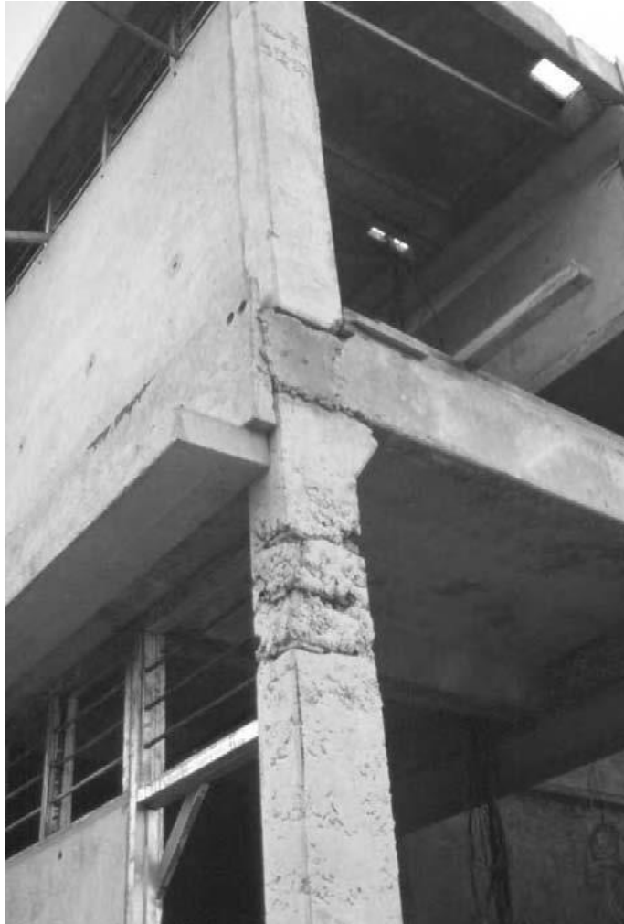
Εικ. 1.2: Προβλήματα συμπύκνωσης σε προκατασκευασμένο υποστύλωμα από σκυρόδεμα. ((Πηγή: “PRECAST CONCRETE STRUCTURES”, Kim S. Eliot)
