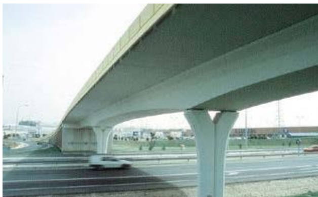
Εικ. 4.25: Προκατασκευασμένη γέφυρα κιβωτιοειδούς διατομής μονής κυψέλης με μεταβλητό ύψος και πλάκα εν προβόλω. (Πηγή: “PRECAST CONCRETE BRIDGES”, state-of-art-report, fib ceb-fip (bulletin 29))
