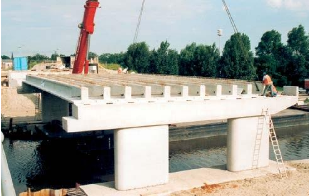
Σχ. 4.6: Παράδειγμα οδογέφυρας πολλαπλών ανοιγμάτων με δοκούς τύπου ανεστραμμένου T. (Πηγή: “PRECAST CONCRETE BRIDGES”, state-of-art-report, fib ceb-fip (bulletin 29))
