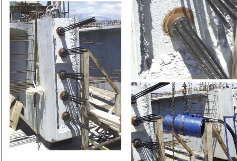
Εικ. 3.16: Τένοντες στο στάδιο της τάνυσης. (Πηγή: “ΠΡΟΕΝΤΕΤΑΜΕΝΟ ΣΚΥΡΟΔΕΜΑ”, Ε. Μπούσιας, Τμήμα Πολιτικών Μηχανικών-Εργαστήριο Κατασκευών)
