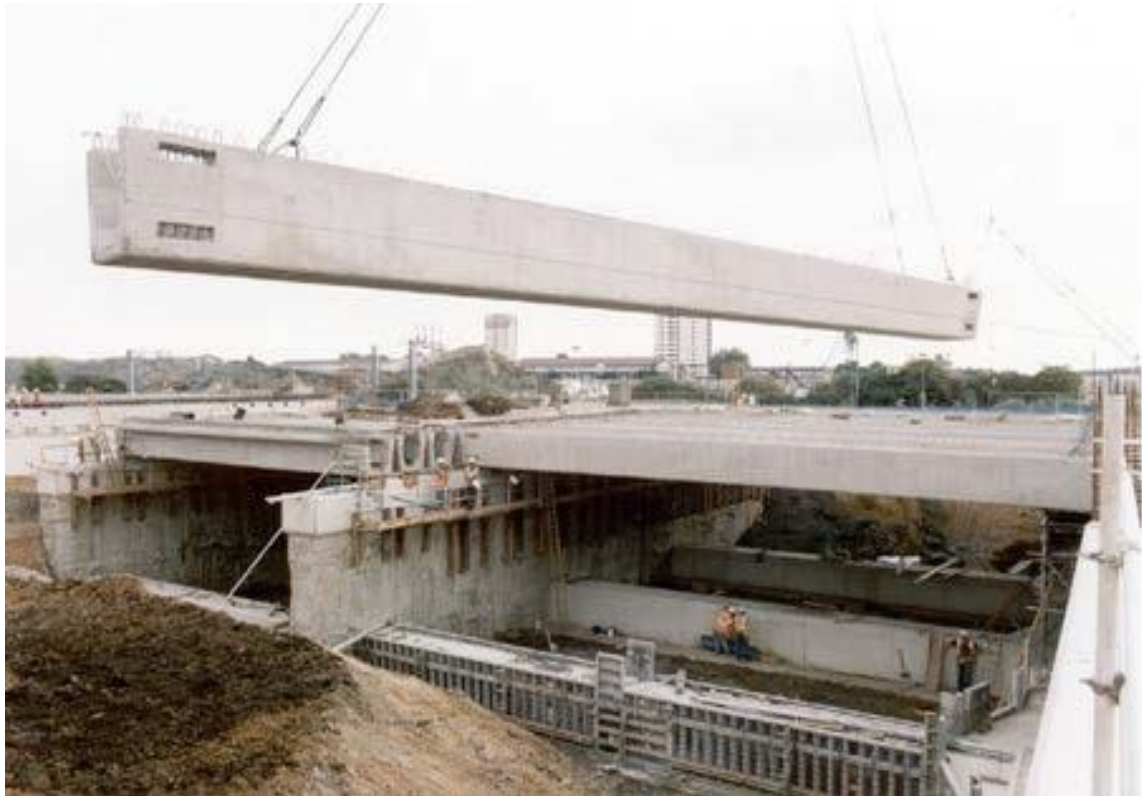
Εικ. 4.18: Γέφυρα με δοκούς μορφής U κατά την ανέγερσή της. (Πηγή: “PRECAST CONCRETE BRIDGES”, state-of-art-report, fib ceb-fip (bulletin 29))
