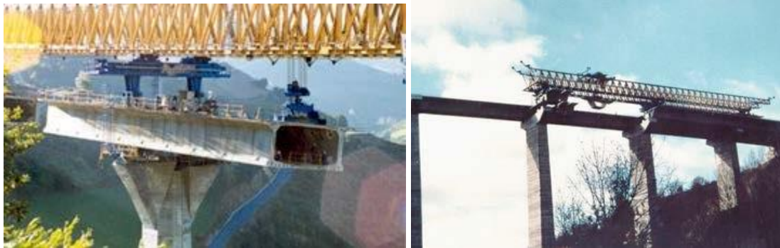
Εικ. 4.31: Γέφυρες με προκατασκευασμένα τμήματα. (Πηγή: “PRECAST CONCRETE BRIDGES”, state-of-art-report, fib ceb-fip (bulletin 29))
