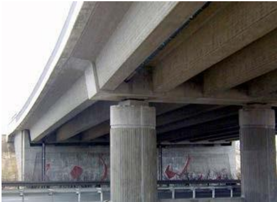
Εικ. 5.11: Ολόσωμη γέφυρα με προκατασκευασμένες ορθογώνιες δοκούς. (Πηγή: "PRECAST CONCRETE BRIDGES", state-of-art-report, fib ceb-fip (bulletin 29))
