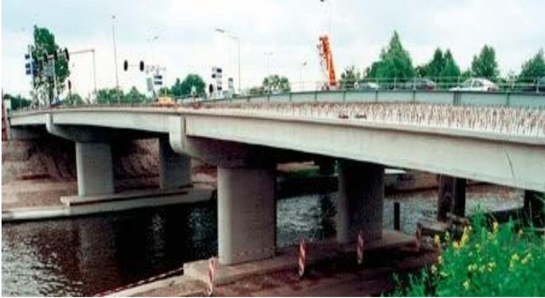
Εικ. 4.10: Γέφυρα με δοκούς τύπου I πάνω από υδάτινο κώλυμα. (Πηγή: “PRECAST CONCRETE BRIDGES”, state-of-art-report, fib ceb-fip (bulletin 29))
