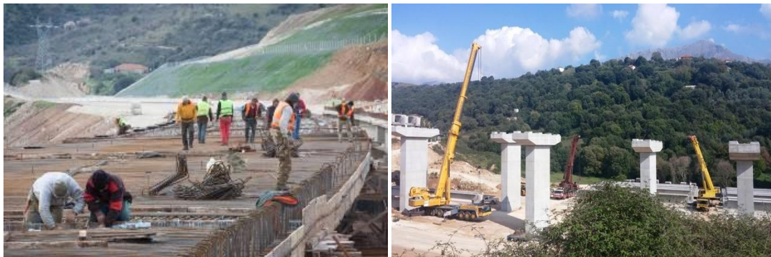
Εικ. 7.2α: Επιτόπου σκυροδέτηση με οπλισμό του άνω τμήματος του καταστρώματος της γέφυρας Γυμνότοπου. (Πηγή: www.e-oikodemos.gr )
