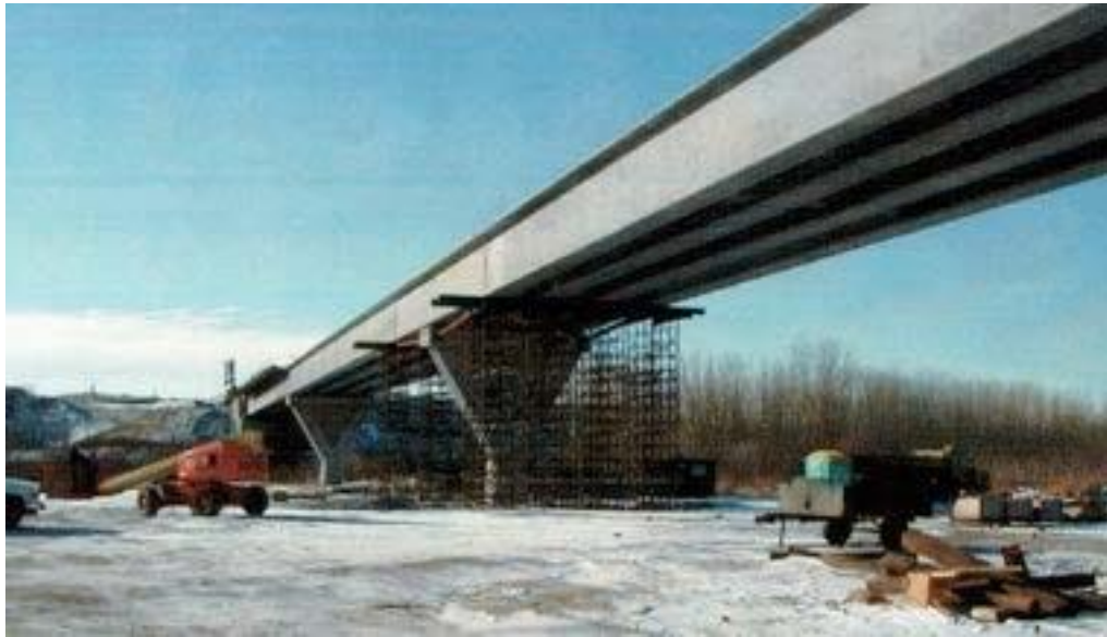
Εικ. 5.13: Ολόσωμη γέφυρα με προκατασκευασμένες δοκούς μορφής I. (Πηγή: “PRECAST CONCRETE BRIDGES”, state-of-art-report, fib ceb-fip (bulletin 29))
