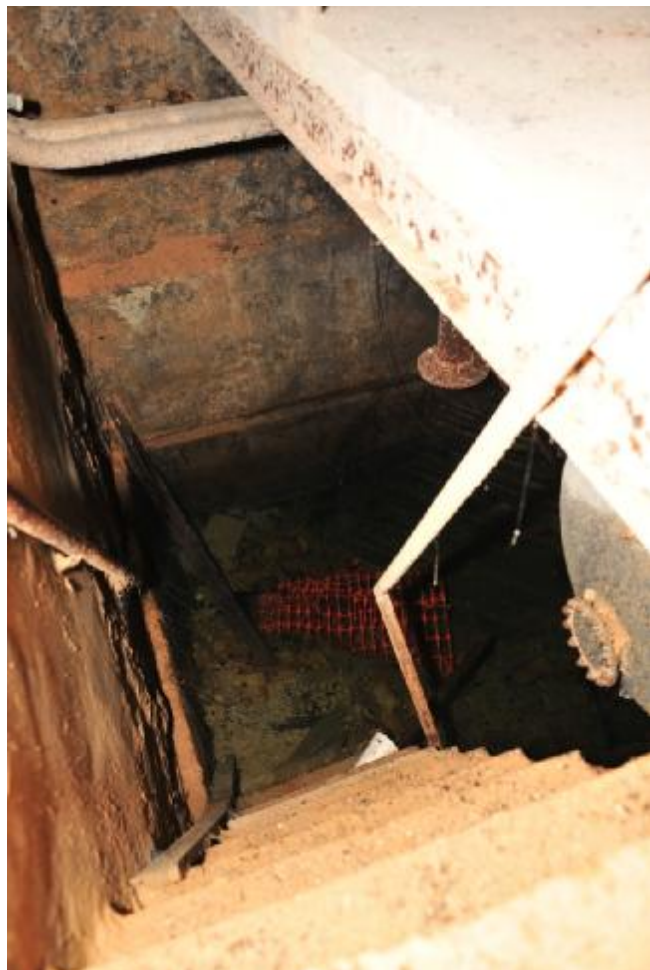
Εικόνα 24. Λιμνάζοντα ύδατα στο υπόγειο Πηγή: Προσωπική λήψη
