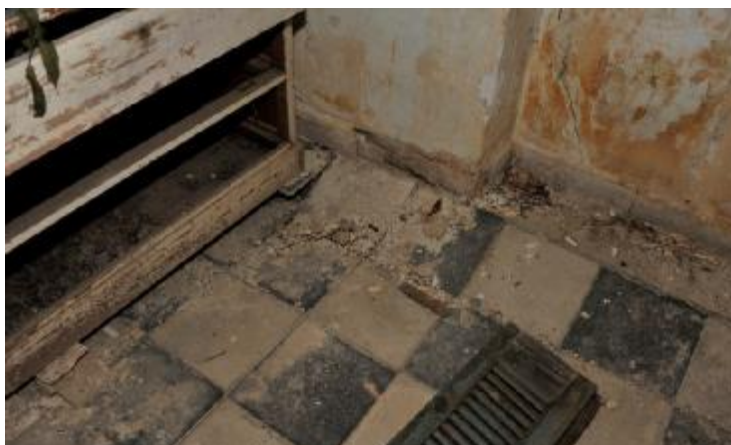
Εικόνα 13. Ισόγειο, σημείο καθίζησης, Δωμάτιο ΙΙ Πιο εμφανές το σύστημα ‘Σκακιέρα’ Πηγή: Προσωπική λήψη
