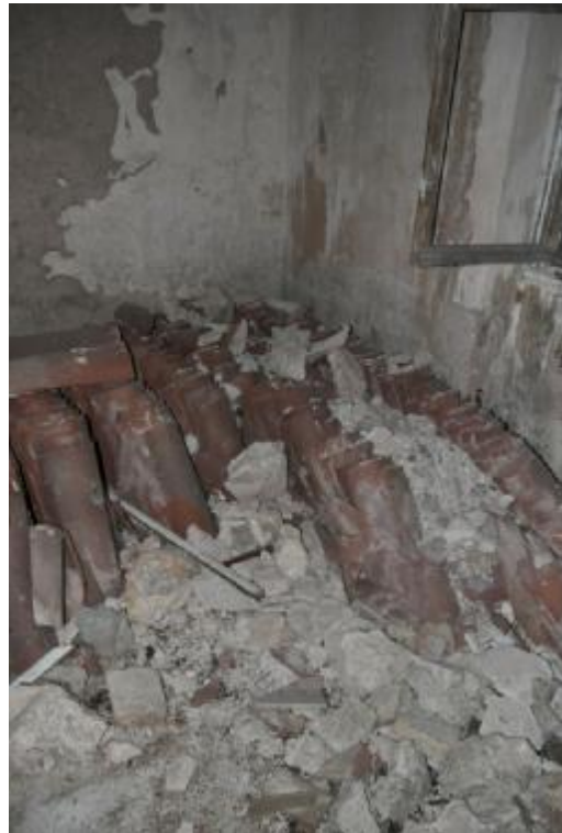
Εικόνα 30. Μπάζα στο Δάπεδο του ορόφου Πηγή: Προσωπική λήψη
