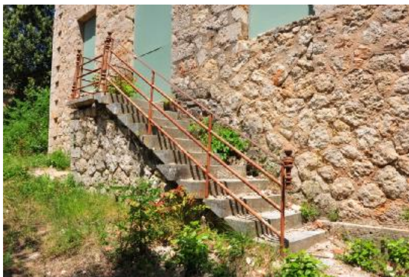
Εικόνα 31. Μοναδική πιο 'ανησυχητική' ρωγμή στη νότια όψη Πηγή: Προσωπική λήψη
