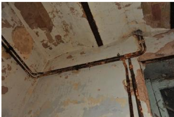
Εικόνα 37. Λεπτομέρεια εγκαταστάσεων θέρμανσης Πηγή: Προσωπική λήψη
