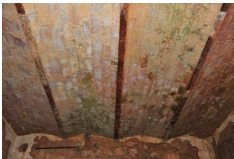
Εικόνα 34. Θολίσκοι ισογείου με πλήρως αποκολλημένο επίχρισμα Πηγή: Προσωπική λήψη
