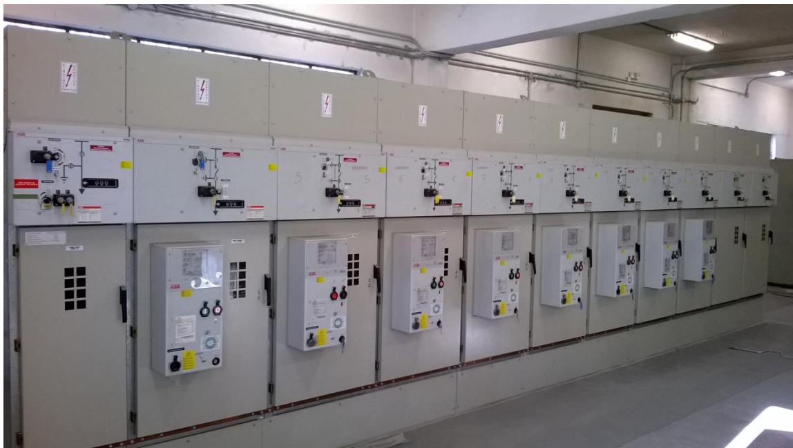
Εικόνα 4: Πεδία Μέσης Τάσης
