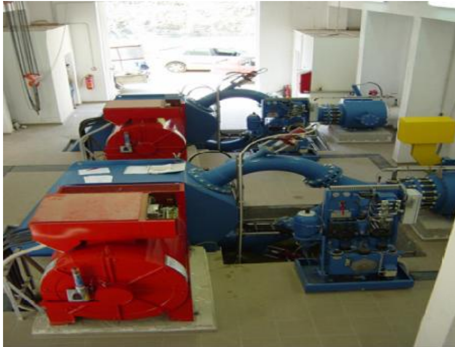
Εικόνα 11: Δύο στρόβιλοι τύπου Pelton (μπλε χρώμα) και οι γεννήτριες (κόκκινο χρώμα).
