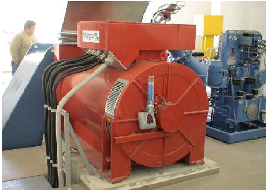
Εικόνα 14: Εξωτερική μορφή ηλεκτρογεννήτριας.
