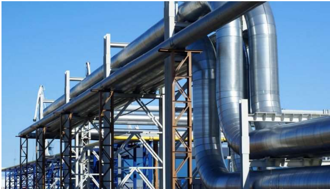
Εικόνα 8:Αγωγός φυσικού αερίου
