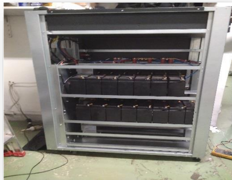
Εσωτερικό Μέρος UPS
