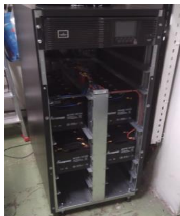
Εξωτερικό Μέρος UPS
