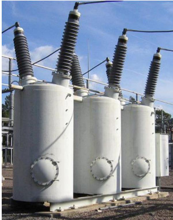
Εικόνα 7: Διακόπτες Ισχύος ελαίου
