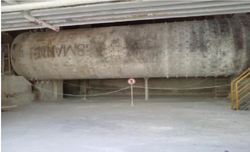
Εικόνα 2.8: Σφαιρόμυλος εργοστασίου TITAN Ελευσίνας.
