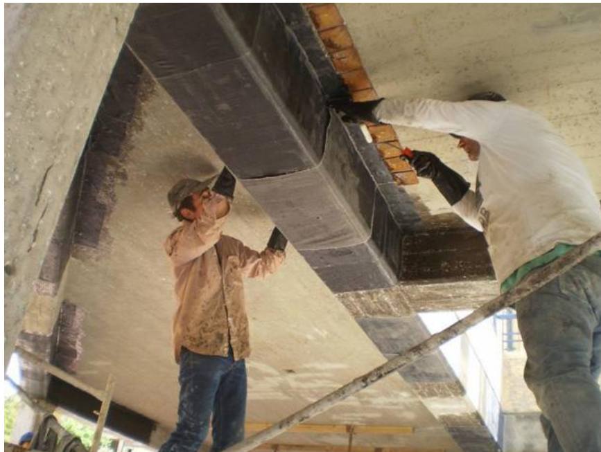
Σχήμα 1.12: Καμπτική και διατμητική ενίσχυση δοκού ενισχυμένης με επικολητά φύλλα από Ινοπλισμένα Πολυμερή [9].
