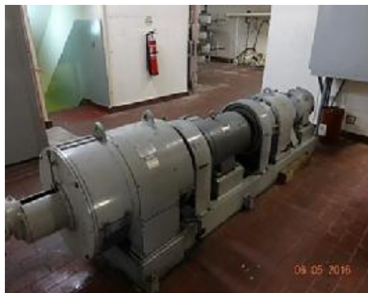
Εικόνα 8. Ρυθμιστής τάσης μονάδας. (πηγή: ΔΕΗ Α.Ε)
